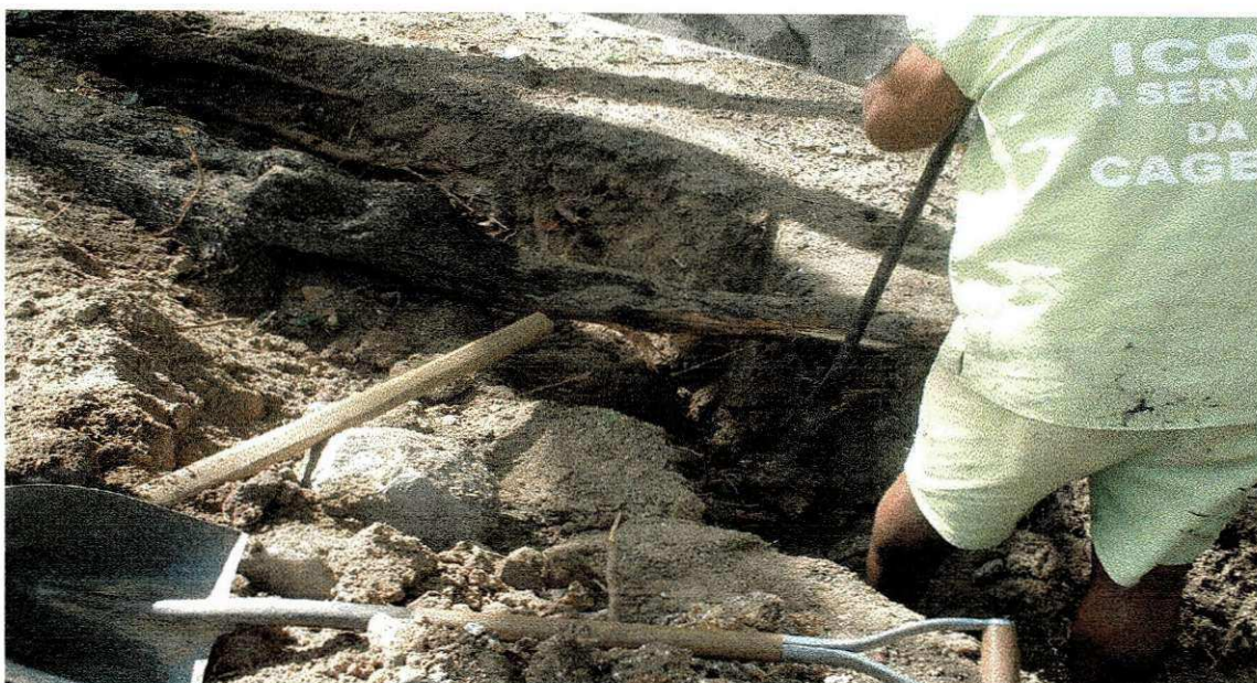
Figura 01 - raiz passando pela vala
