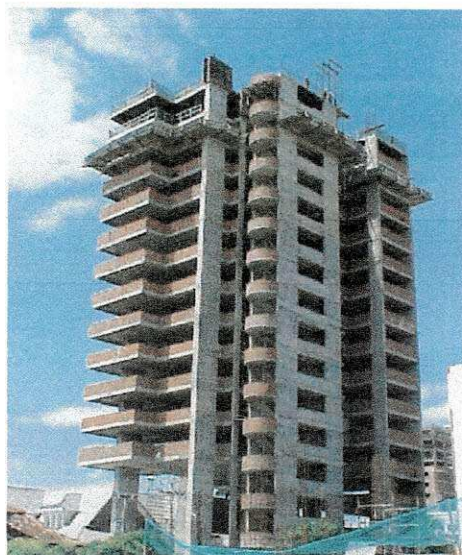
Figura 16. Estrutura de Fechamento.
