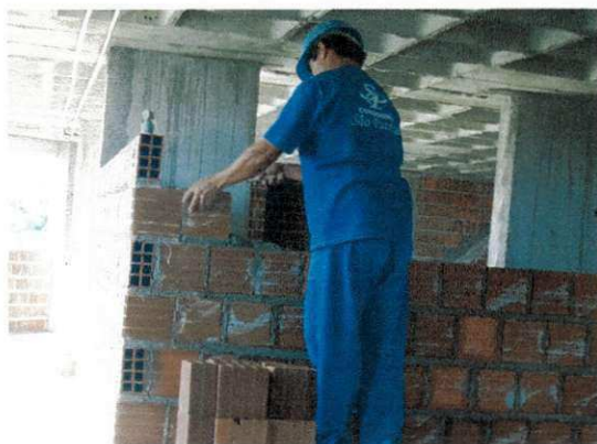
Figura 51 – Levantamento da alvenaria de vedação de um dos apartamentos do condomínio São Patrício.
