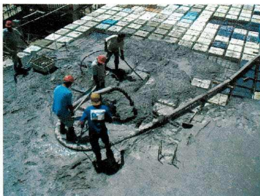
Figura 47 – Lançamento do concreto usinado na laje. Logo acima, um operário utilizando vibrador para homogeneizar o concreto.
