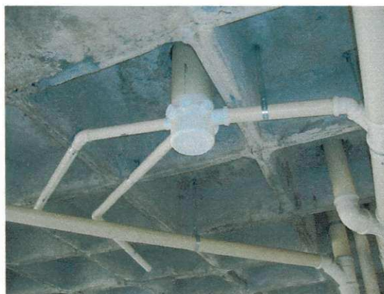
Figura 54 – Tubulações sanitárias passando pela laje. (Repare nas presilhas sustentando as tubulações)
