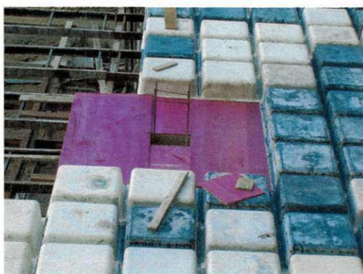
Figura 45 – Detalhe da forma no encontro do pilar com a laje, onde ficará a laje maciça para combater o efeito de punção.
