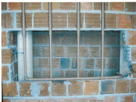
Figura 53 – Colunas onde serão instalados os medidores individuais. Atrás, poço para passagem de tubulações de esgoto.
