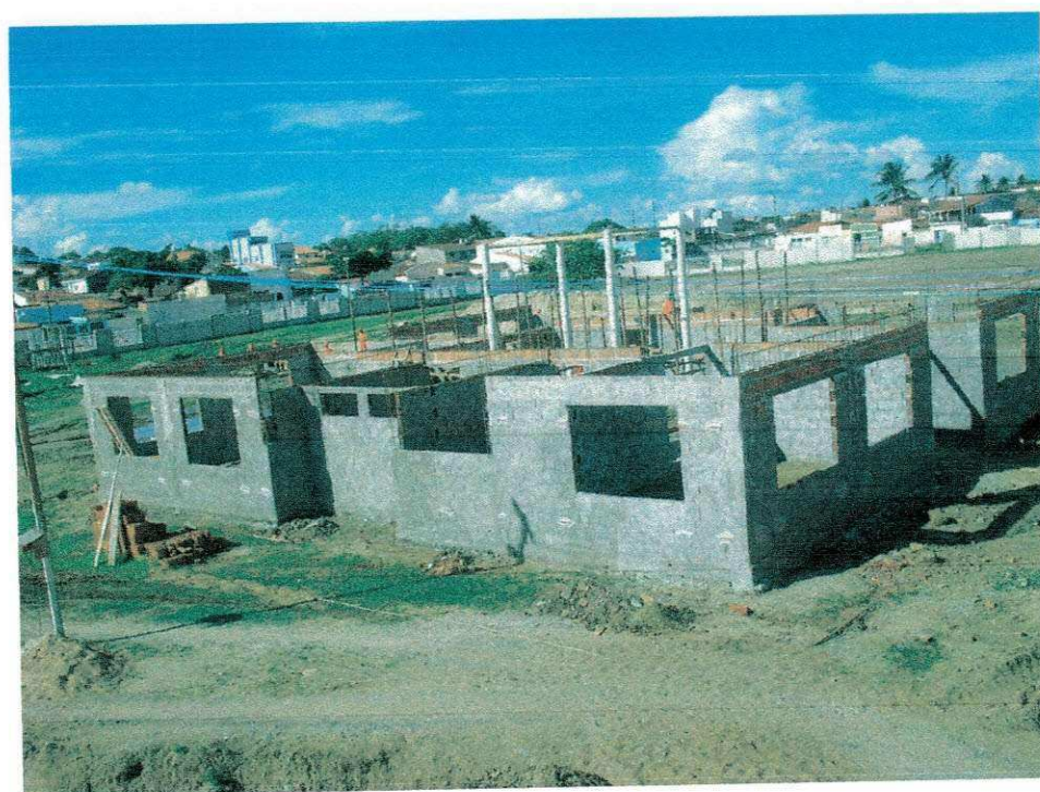
FIGURA 30 – Elevação em alvenaria de tijolos cerâmicos de ½ vez do centro de capacitação .
