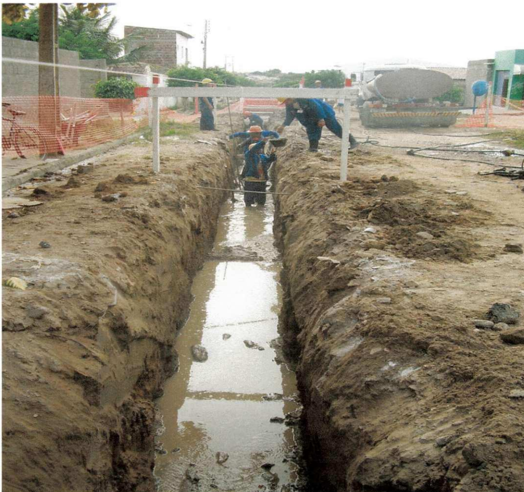
Figura 2: Vala aberta com presença de água
