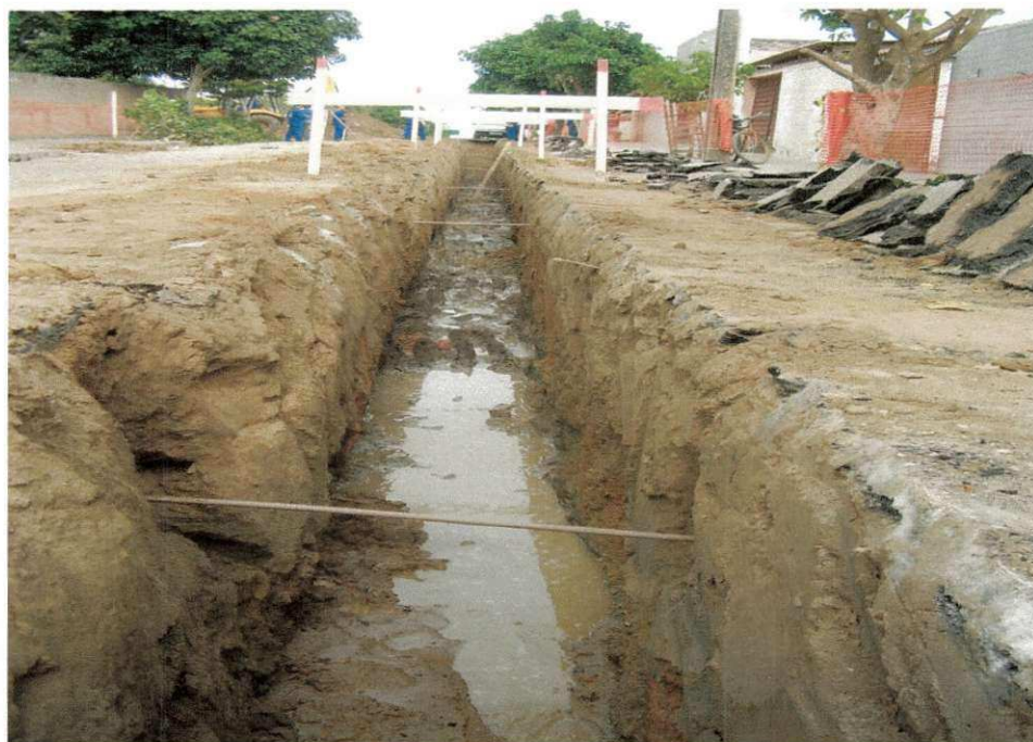
Figura 1: Vala aberta com presença de interferências de canalizações
