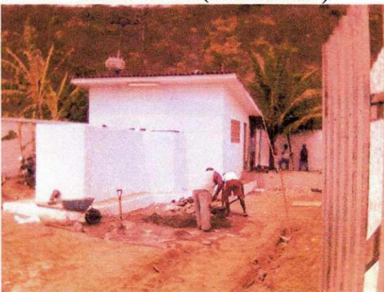
Foto:11 - Casa de bomba (Algodão de Jandaira)
