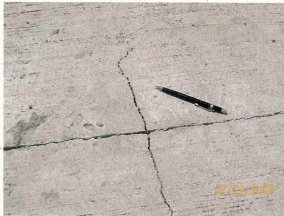
Figura 12 – Trinca no pavimento
