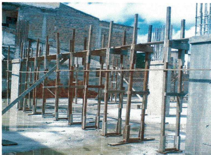
Figura 4.16 – Escoramento tipo garfo
