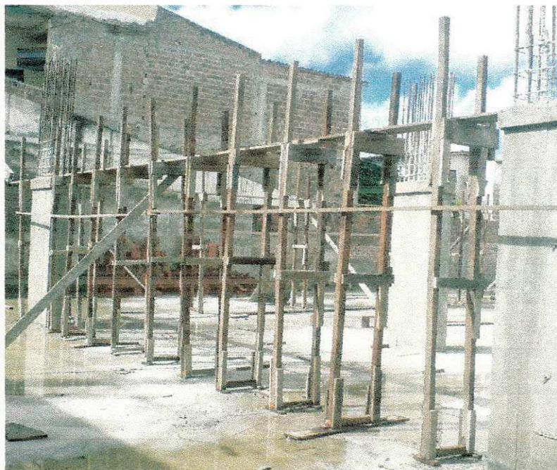
Figura 4.15 – Escoramento tipo garfo
