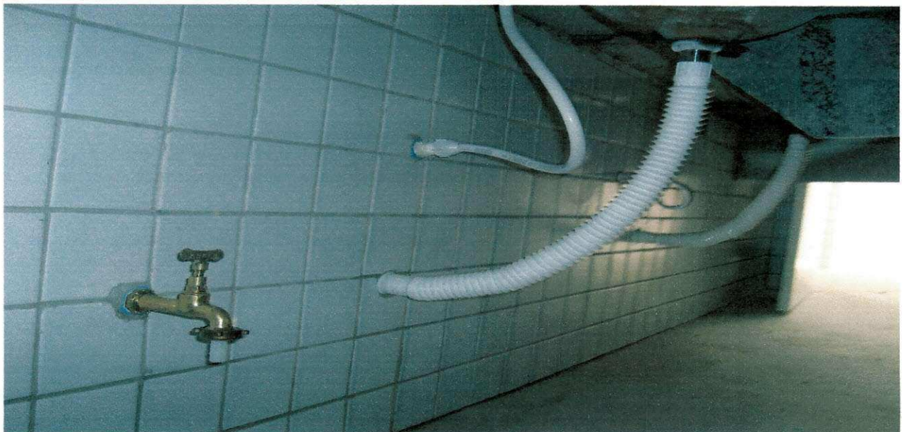
Figura 30: Materiais e equipamentos, utilizados na distribuição e captação de água fria.
