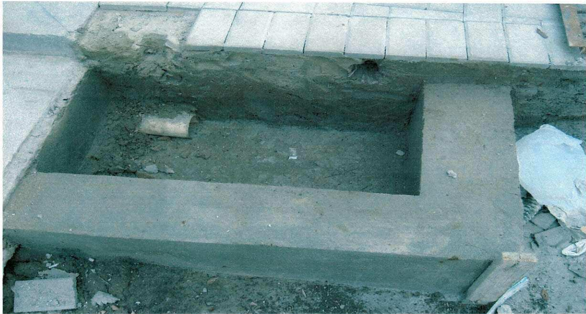
Figura 31: Captação de águas pluviais.
