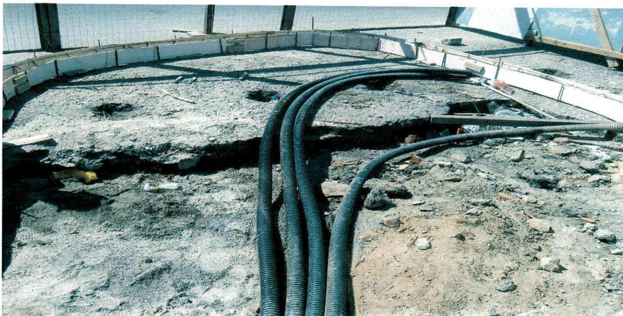
Figura 36: Tuboflex, utilizados na distribuição dos cabos de energia.
