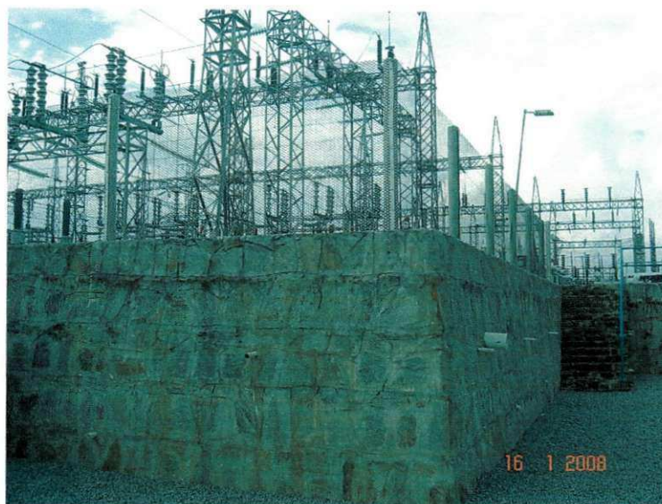
Figura 43 – Alambrado de proteção em muro de arrimo SE CGD
