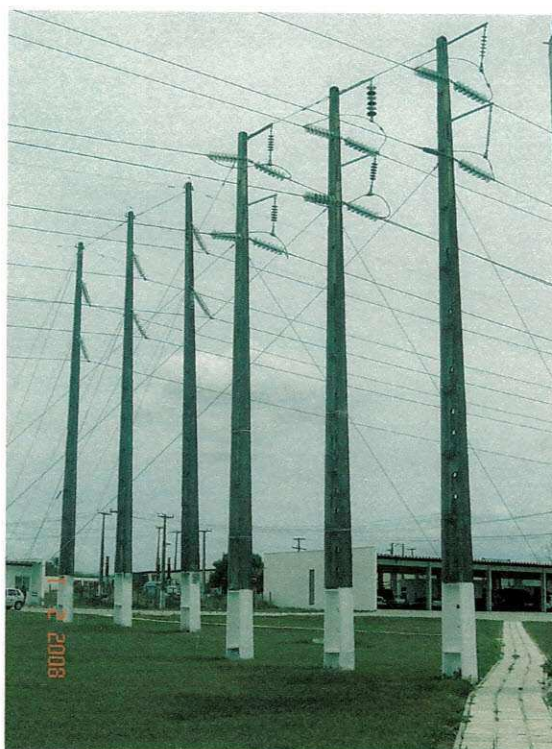
Figura 30 – LT de 138kV
