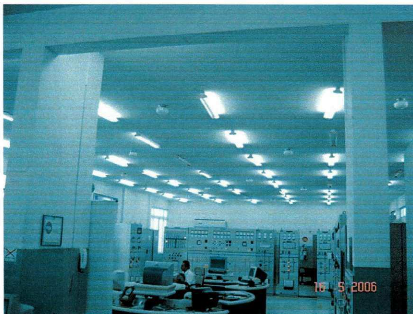
Figura 47 – Luminárias atuais da casa de comando SE CGD
