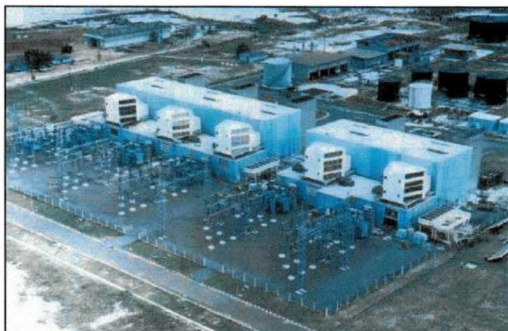
Figura 21 – Usina térmica de Camaçari
