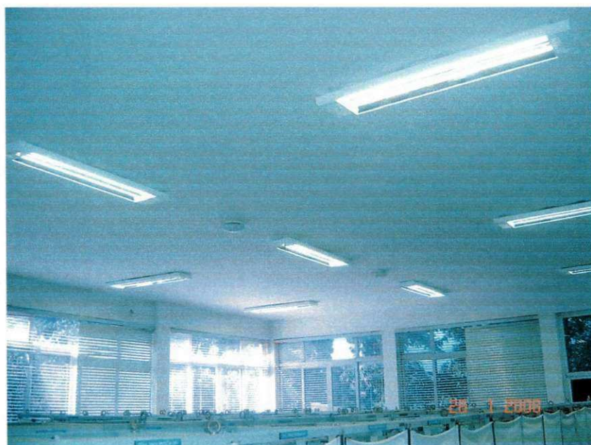
Figura 48 – Novas luminárias que serão aplicadas na casa de comando SE CGD
