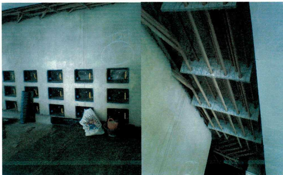
Figura 7 e 8 Detalhe dos quadros de medição e divisão das tubulações
