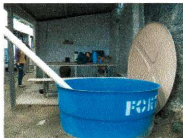
Figura 20 – Armazenamento de água da chuva
