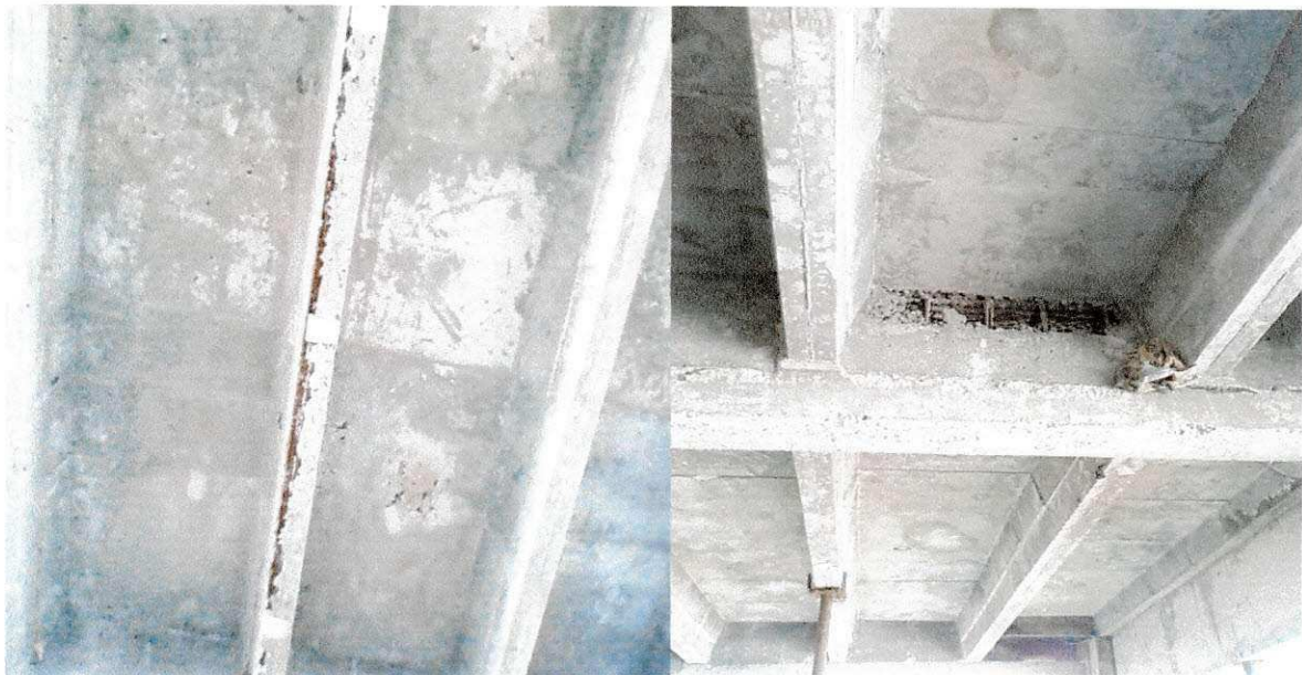
Figura 29. Problemas na concretagem
