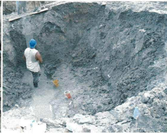
Figura 40 – Desmoronamento de vala.
