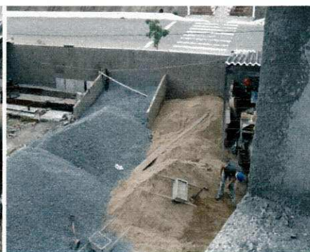
Figura 34- Agregados graúdos e miúdos.
