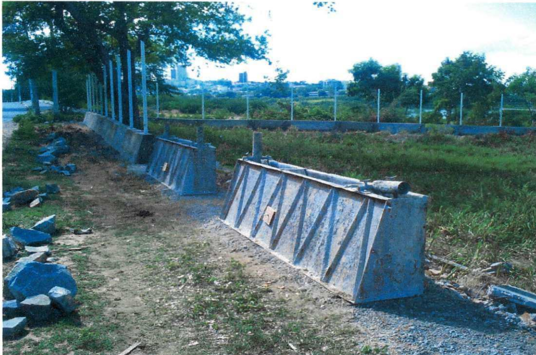
Fig. 18 _ tubos sem grades.
