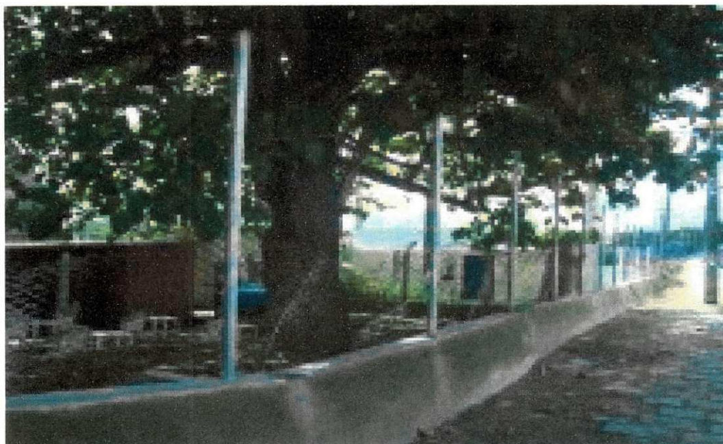
Fig. 19 _ tubos sobre a base sem grades.
