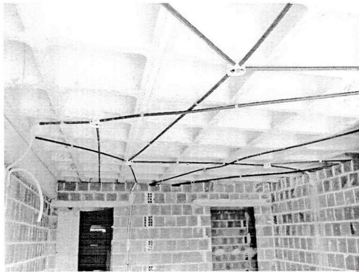
Figura 10 - Eletrodutos rígidos instalados no teto e flexíveis nas paredes.
