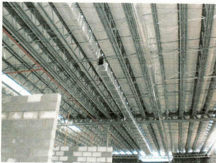
FIGURA 20 – Dutos de ar condicionados
