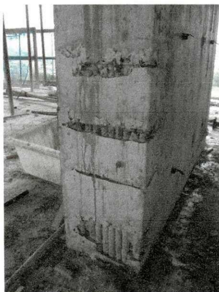
Figura 35 - Ferragem justaposta evitando passagem na nata do concreto.
