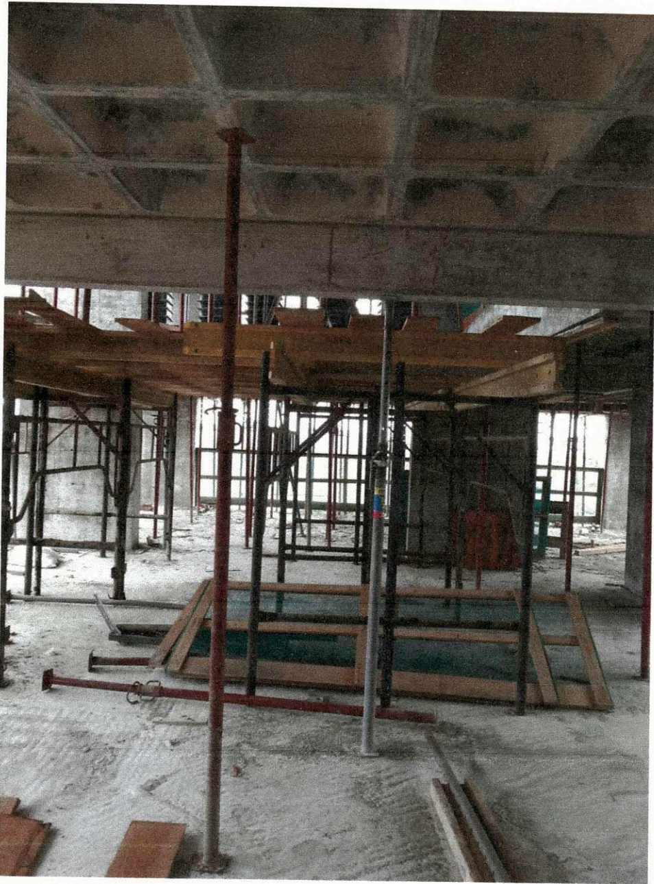
Figura 7-a: sistema de escoramento metálico para lajes
