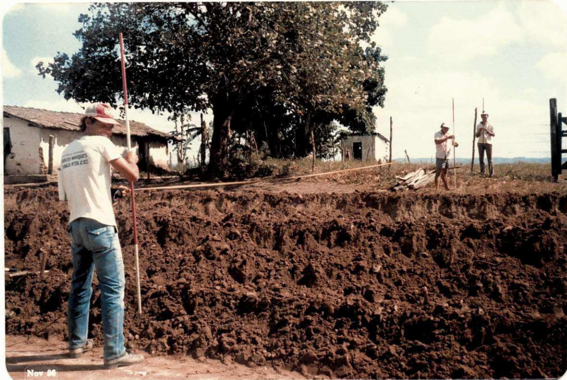
Equipe de Topografia marcando a largura de eixo da rodovia para locação da camada de base.
