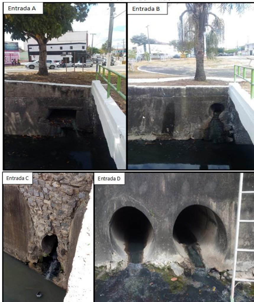
Figura 6 – Documentário fotográfico das contribuições de esgoto das Entradas A, B, C e D no canal do Prado
