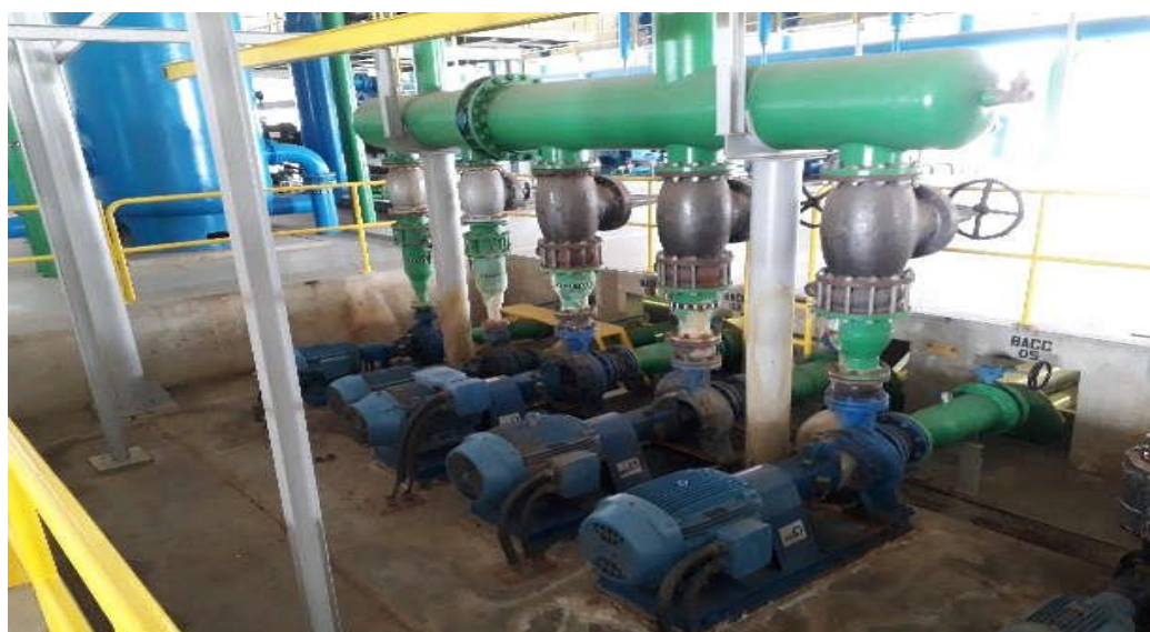
FIGURA 14: BOMBAS DE CONDENSAÇÃO.
