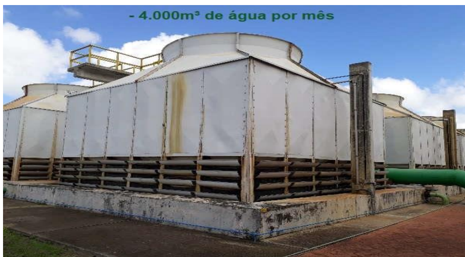
FIGURA 23: TORRE DE RESFRIAMENTO.
