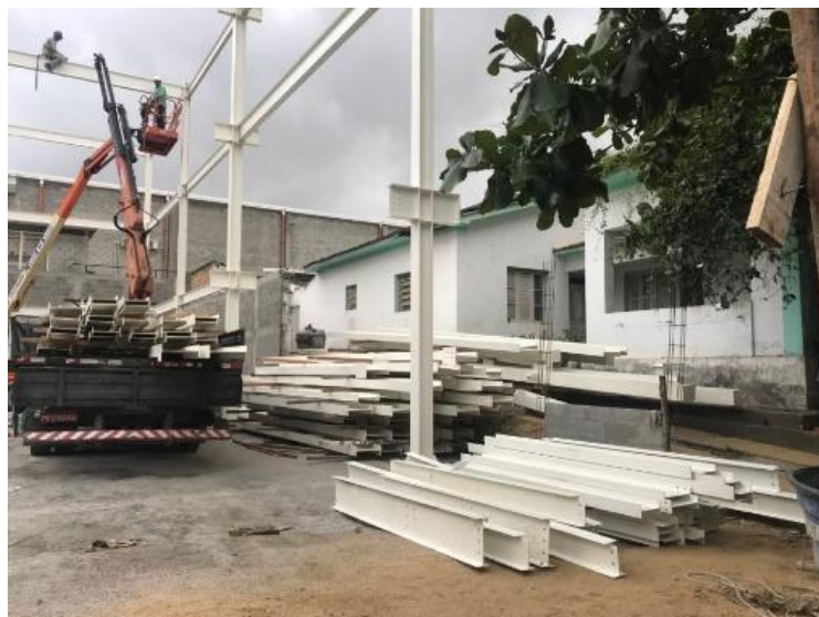
Figura 23 - Erro 1 - Armazenamento excessivo de peças no canteiro.
