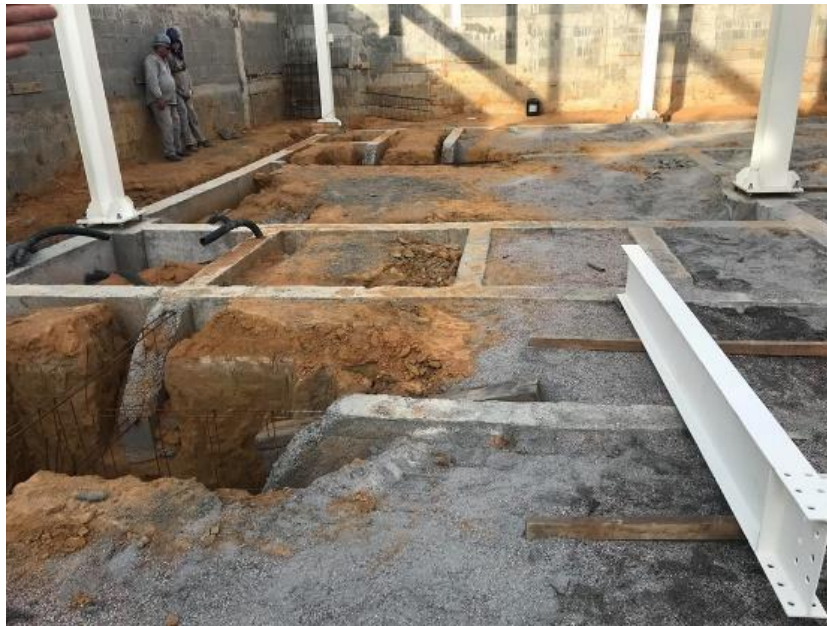
Figura 25 - Erro 3 – Cintas danificadas pelo “munck”
