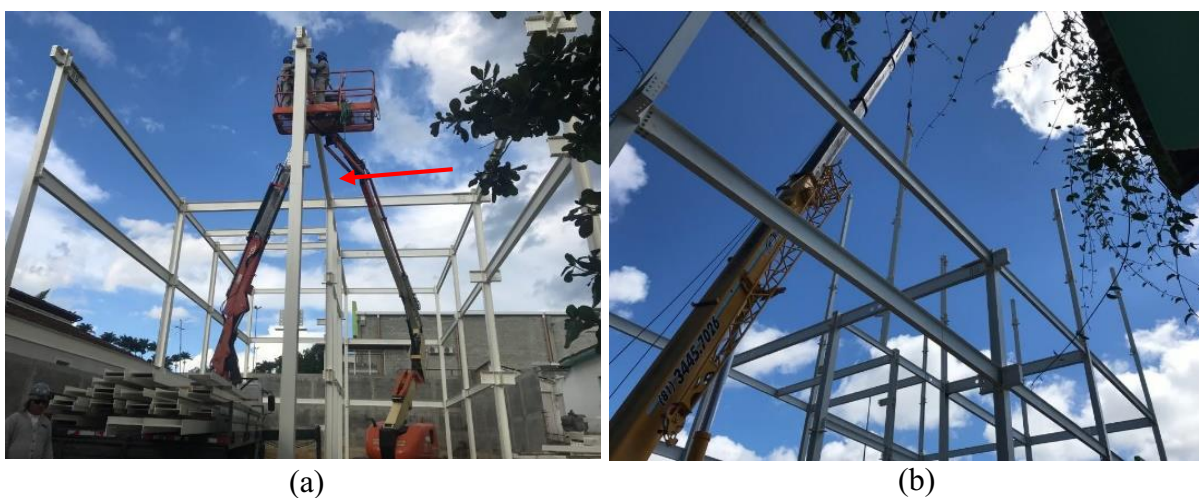
Figura 24 - Erro 2 - Falha na sequência de montagem.
