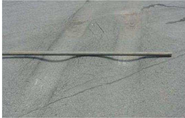
Figura 22-Exemplo de deformação permanente em pavimento asfáltico
