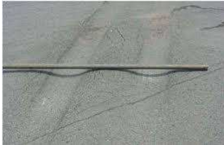
Figura 3: Exemplo de deformação permanente em pavimento asfáltico
