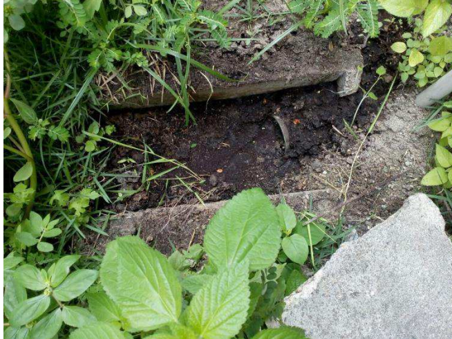
Figura 26 - Hidrômetro do centro de extensão na UFCG completamente soterrado
