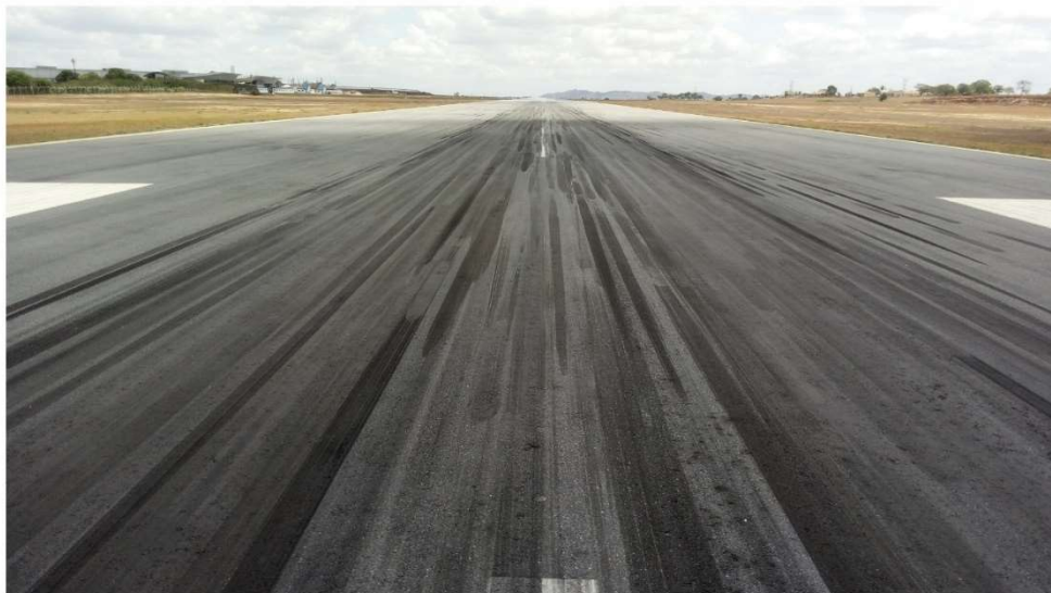
Figura 27: Focos de emborrachamento em cada uma de três zonas asfálticas ( Terços ) da pista principal do Aeroporto de Campina Grande (PB).
