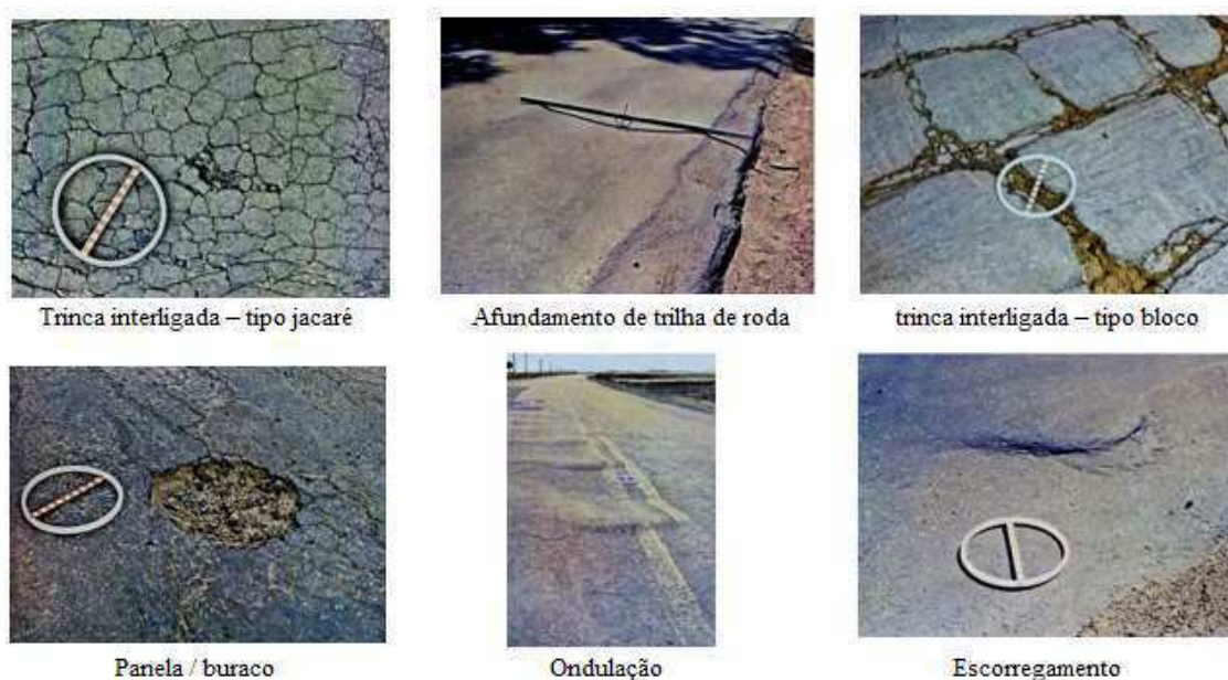
Figura 4: Imagens de exemplos de defeitos em pavimentos flexíveis
