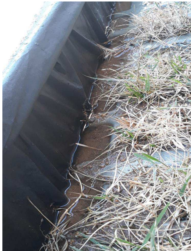
Figura 38: Escoamento superficial observado acima dos cobogramas.
