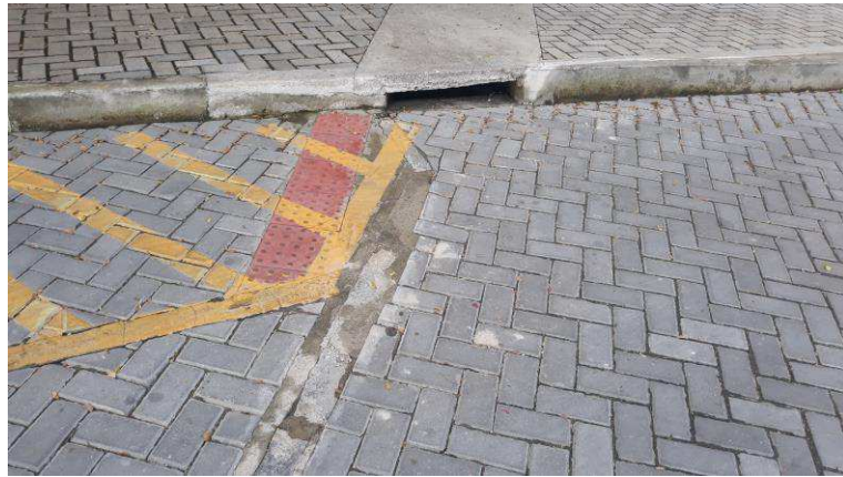
Figura 12: Boca de lobo.
