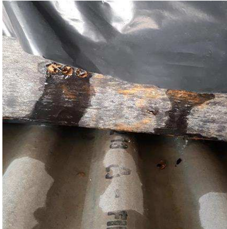
Figura 37: Água escoada caindo na telha através dos furos na madeira que limita a área de estudo.
