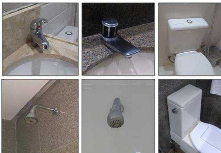
Figura 8 - Aparelhos hidrossanitários dos quartos do hotel.
