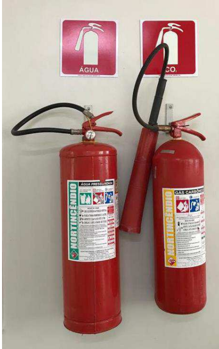
Figura 18 - Extintores do tipo A e BC
