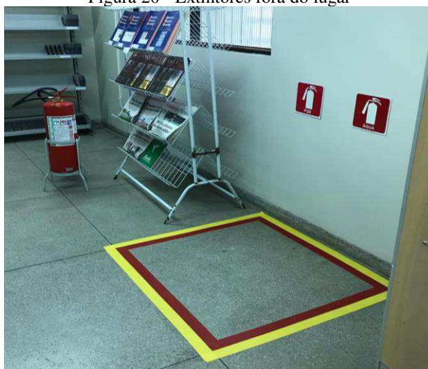
Figura 20 - Extintores fora do lugar
