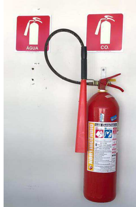
Figura 19 - Falta de equipamento
