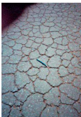
Figura 2 - Trincas couro de jacaré (Bernucci et al., 2010)
