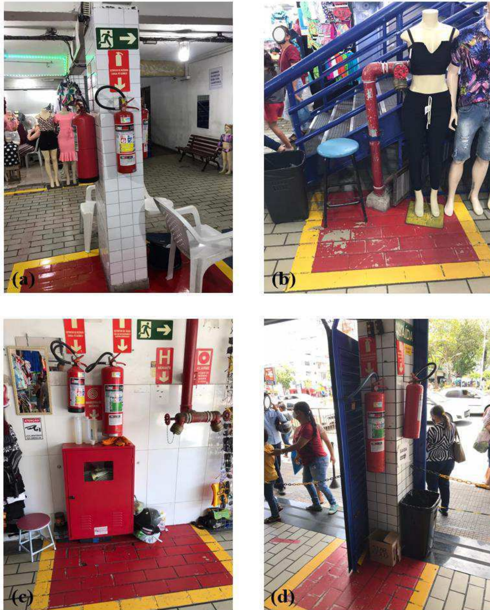
Figura 9: Presença de obstáculos em hidrantes e extintores ao longo da edificação.
