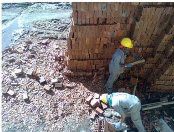
Figura 19 – Fotografia com ilustração do desperdício de material.
