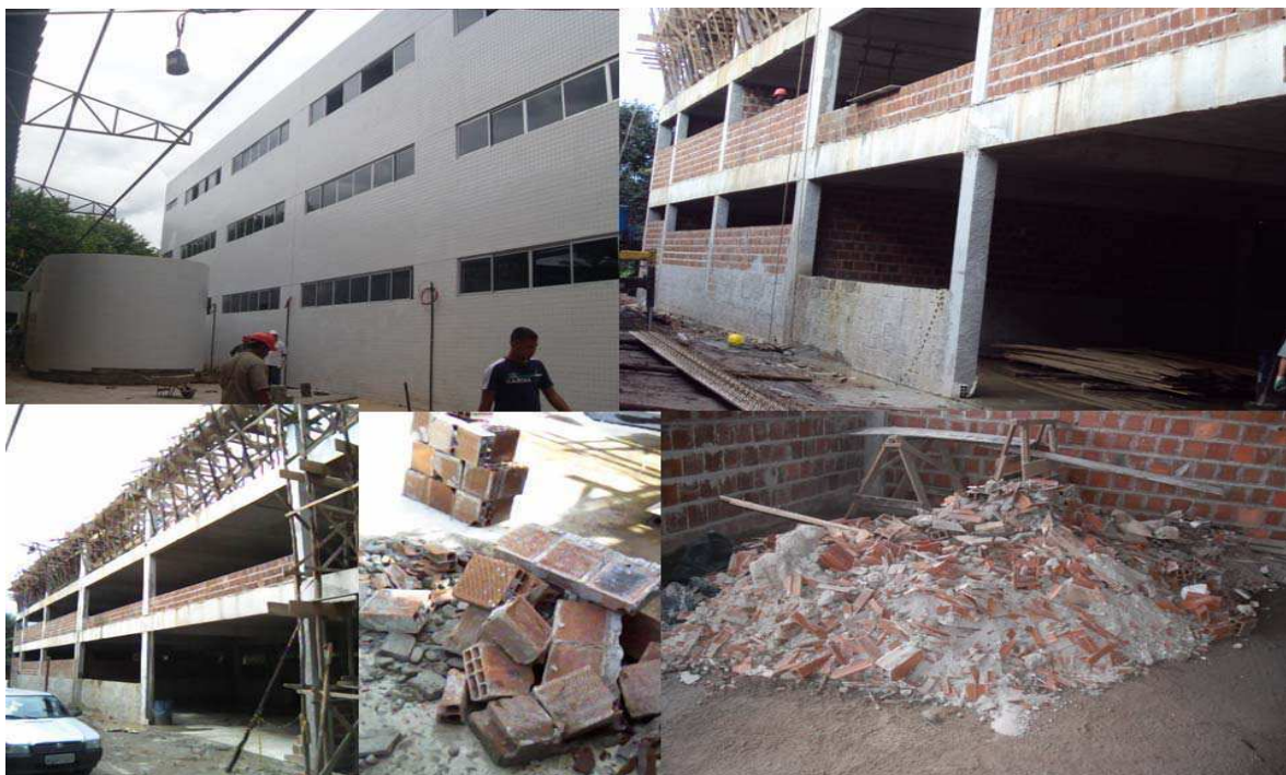
Figura 17 - Sequência de fotos da obra 2 com destaque para paredes demolidas durante a obra por erro de execução ou em virtude do projeto estar obsoleto.
