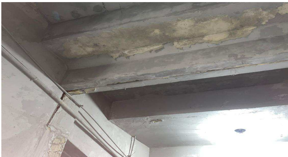
Figura 31: Descascamento provocado por infiltração no acesso das delegações
