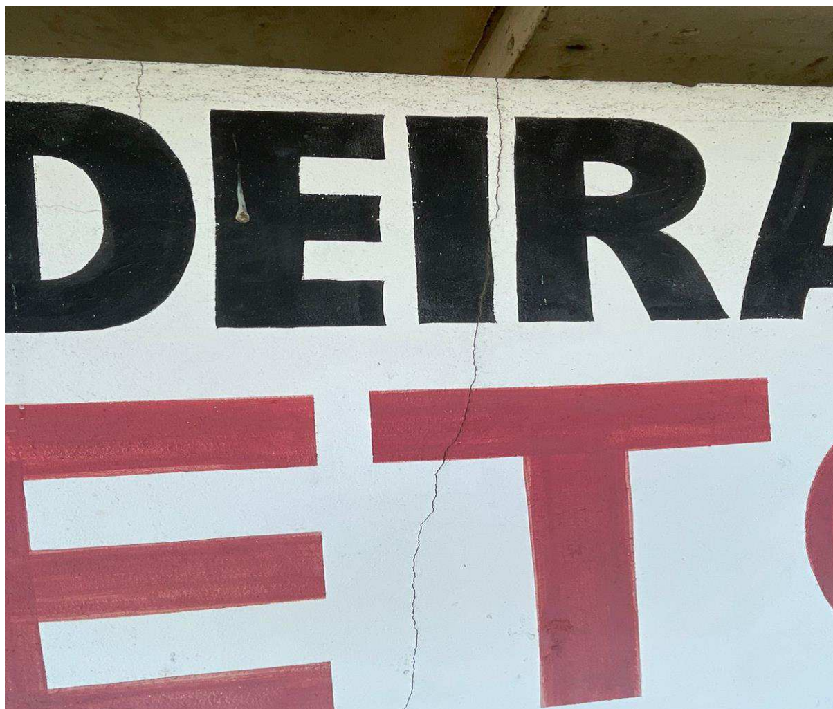
Figura 72: Rachadura em parede de alvenaria no setor das cadeiras
