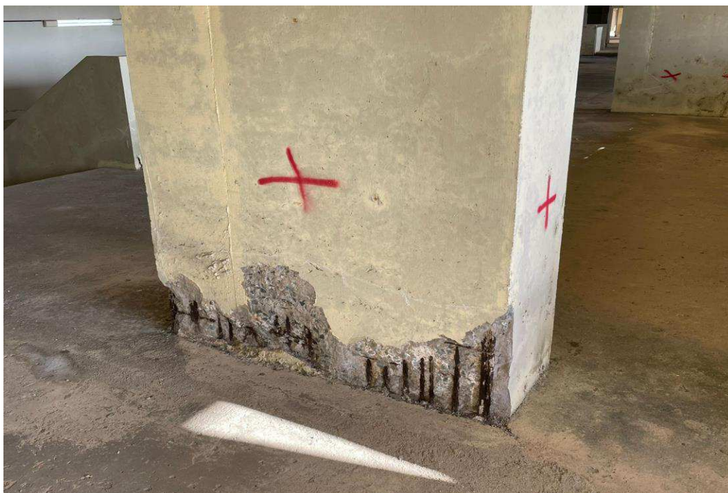
Figura 46: Armadura exposta oxidada em pilar do setor das cadeiras
