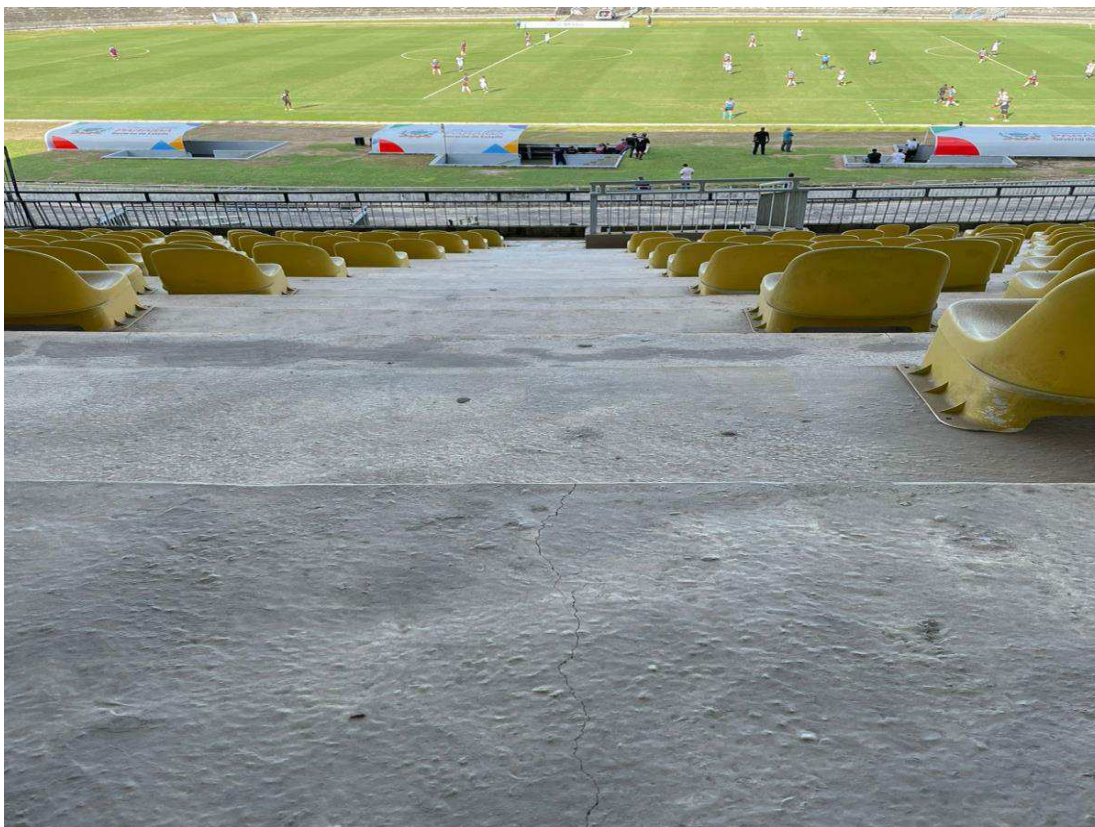
Figura 73: Trinca no elemento do setor das cadeiras
