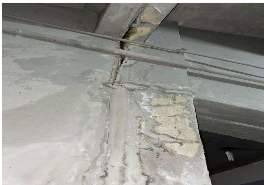
Figura 32: Descascamento provocado por infiltração no acesso das delegações
