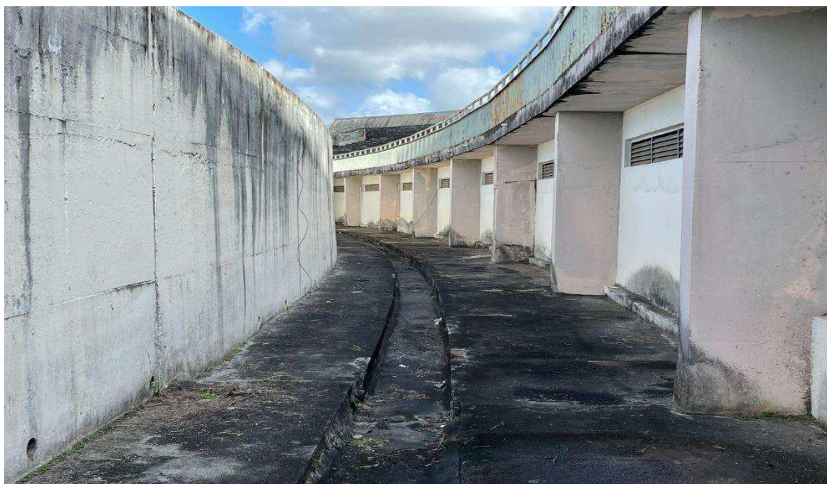
Figura 57: Pintura Corroída no fosso do estádio
