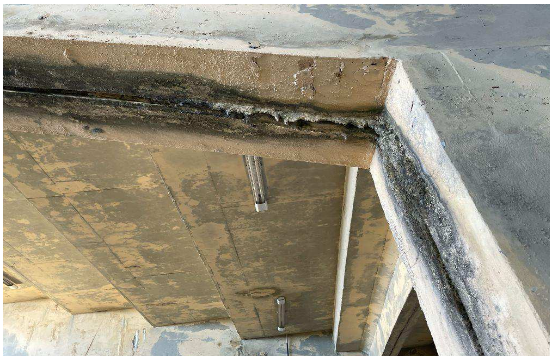
Figura 22: Infiltração de água no setor sol
