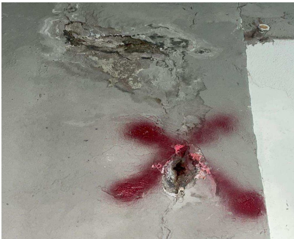
Figura 44: Armadura exposta oxidada nos WC's do setor sombra
