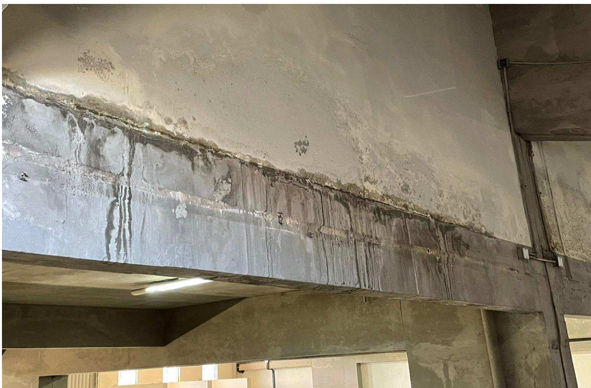
Figura 17: Infiltração de água pela estrutura no setor sombra
