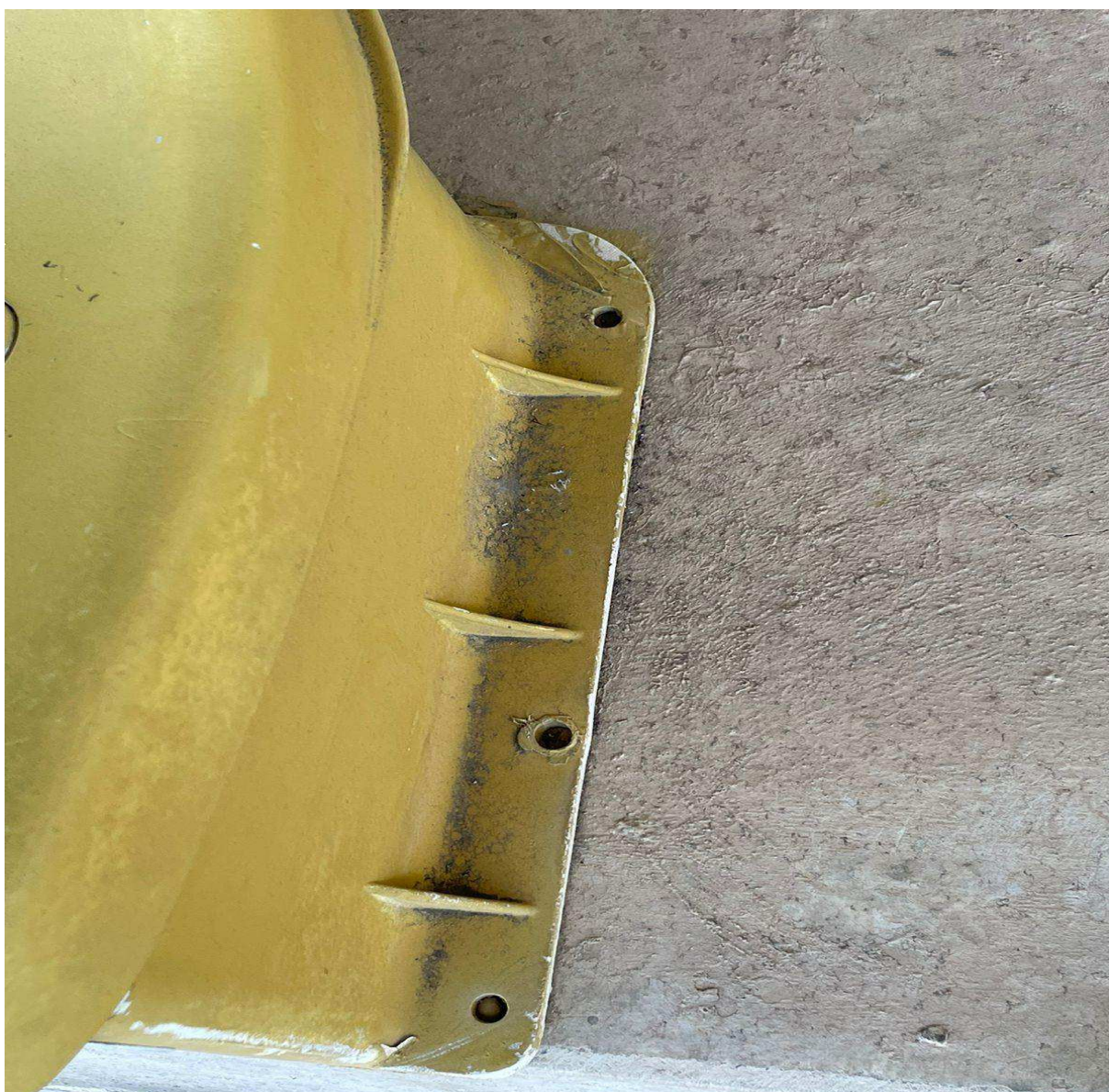
Figura 76: Pontos de risco para infiltrações, arquibancada sombra
