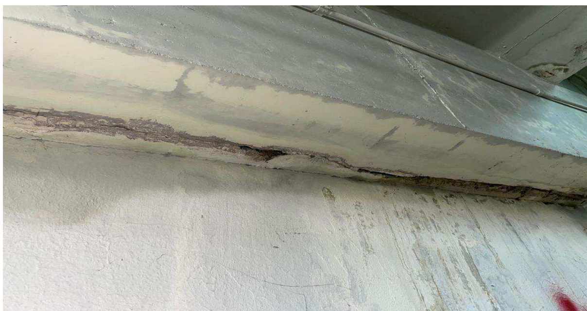
Figura 71: Rachadura em elemento sobre os vestiários
