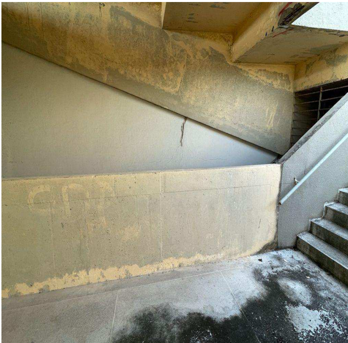
Figura 65: Piso desgastado na circulação do setor sol
