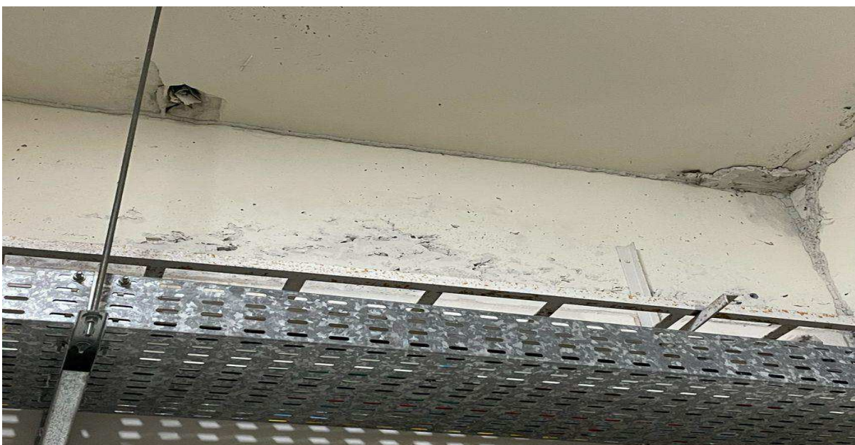
Figura 67: Segregação do concreto em viga dos vestiários
