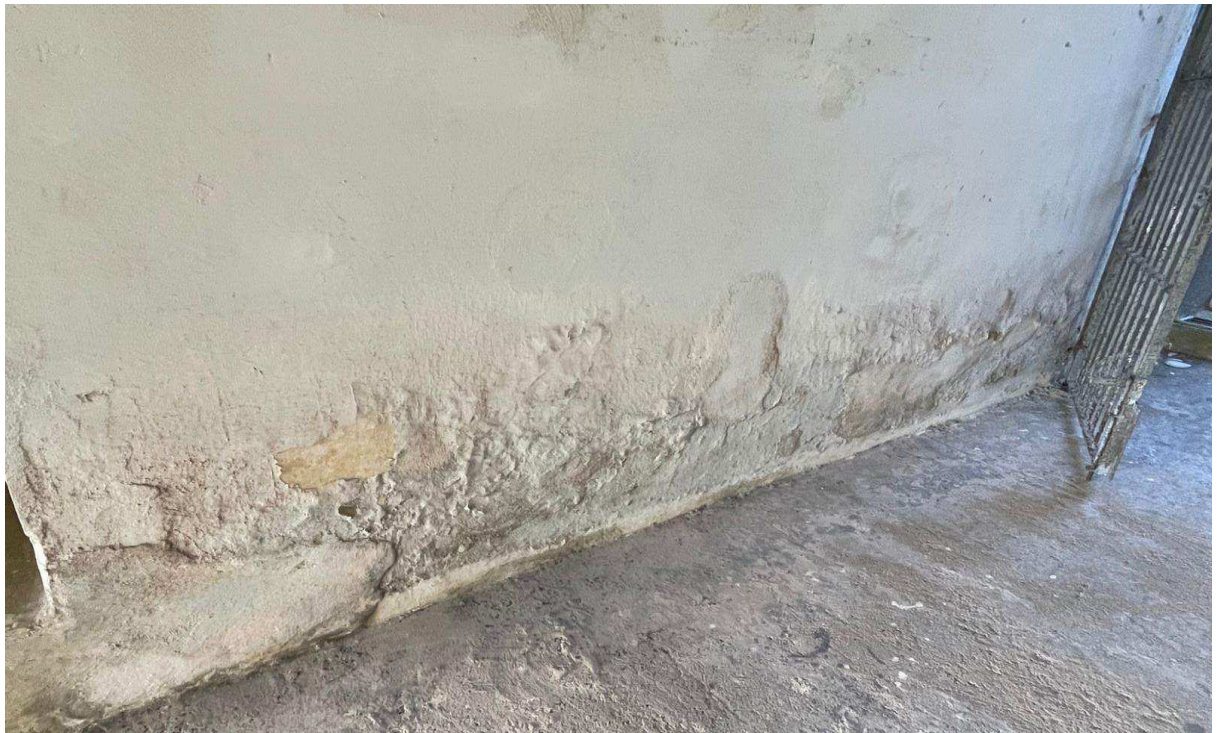
Figura 36: Descascamento provocado por infiltração no setor de circulação das cadeiras
