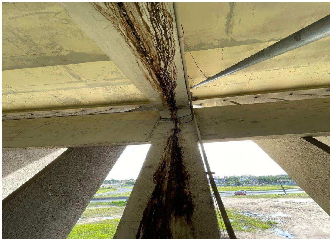
Figura 21: Infiltração de água no setor das cabines de imprensa
