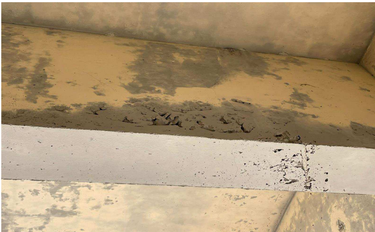
Figura 68: Segregação do concreto em viga no setor das cadeiras
