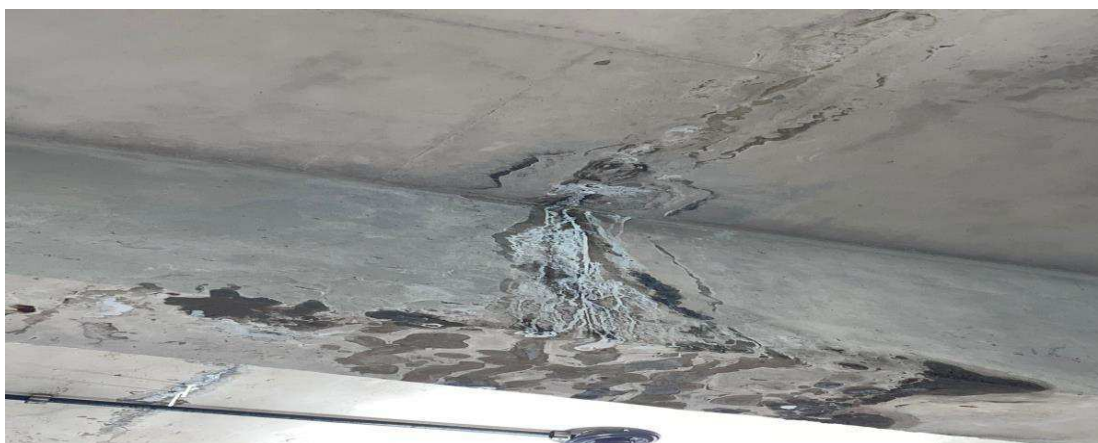
Figura 14: Infiltração de água pela estrutura no setor sombra
