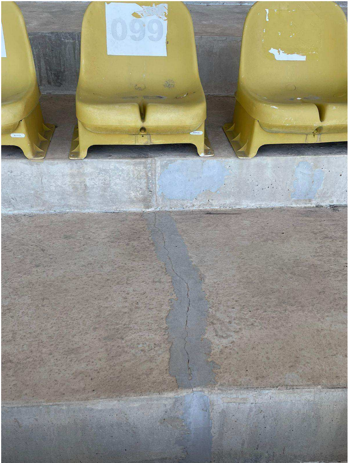
Figura 75: Trinca no setor das cadeiras
