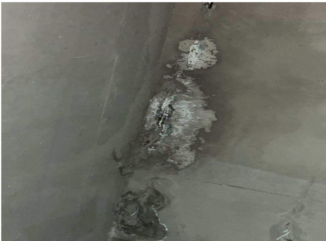
Figura 18: Infiltração de água nos Wc's do setor sombra
