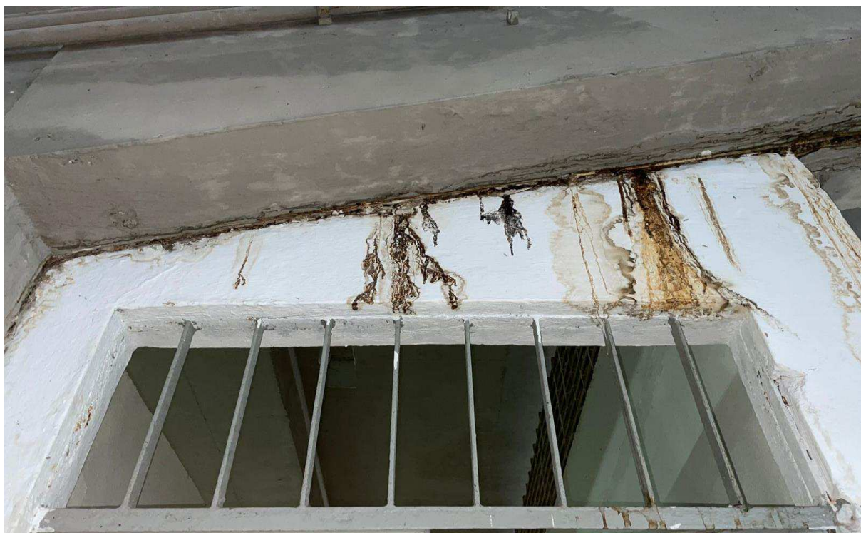
Figura 55: Pintura corroída no setor sombra
