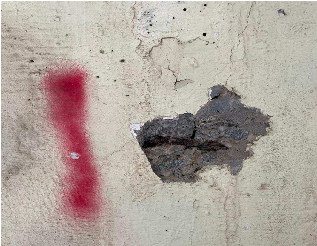
Figura 52: Armadura exposta oxidada no setor dos camarotes
