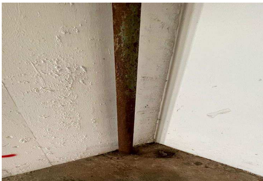
Figura 23: Oxidação do elemento hidráulico no acesso das delegações
