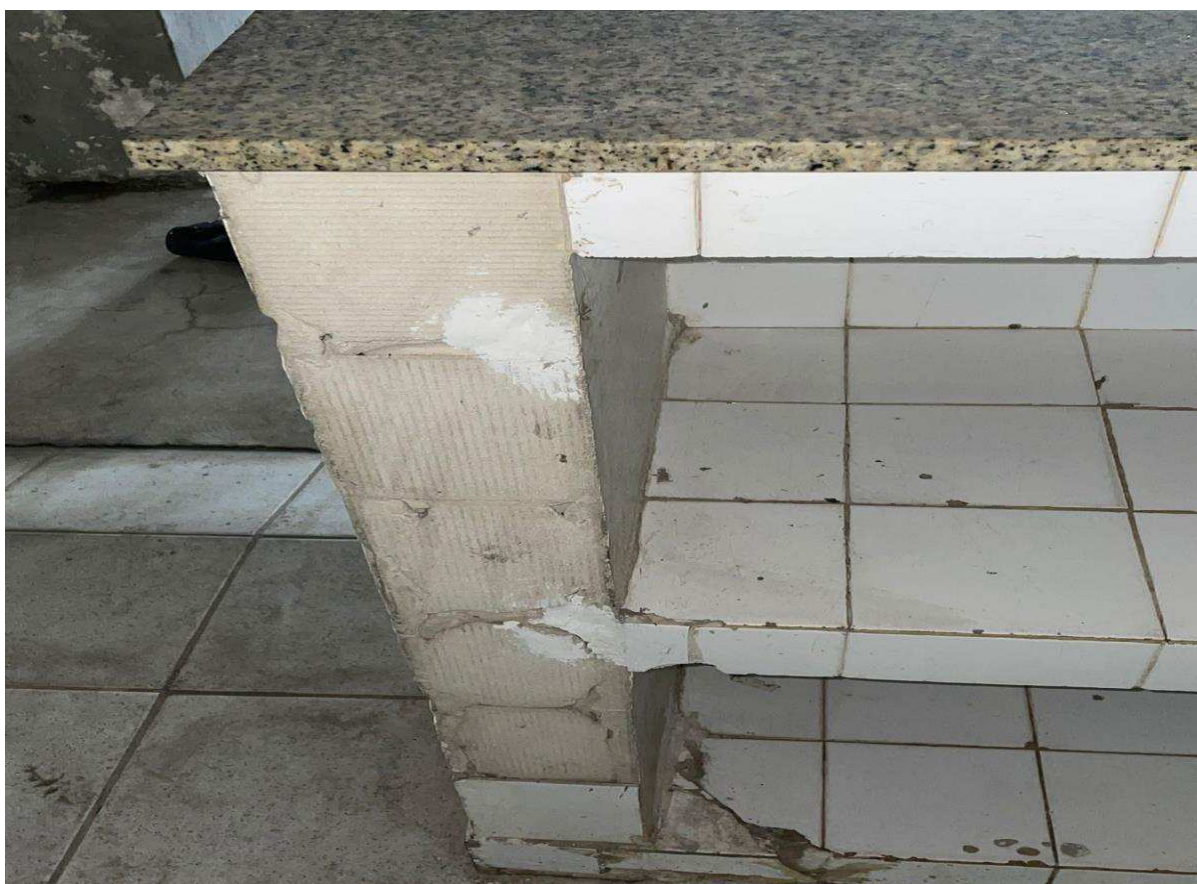
Figura 58: Descolamento do revestimento no bar do setor sombra
