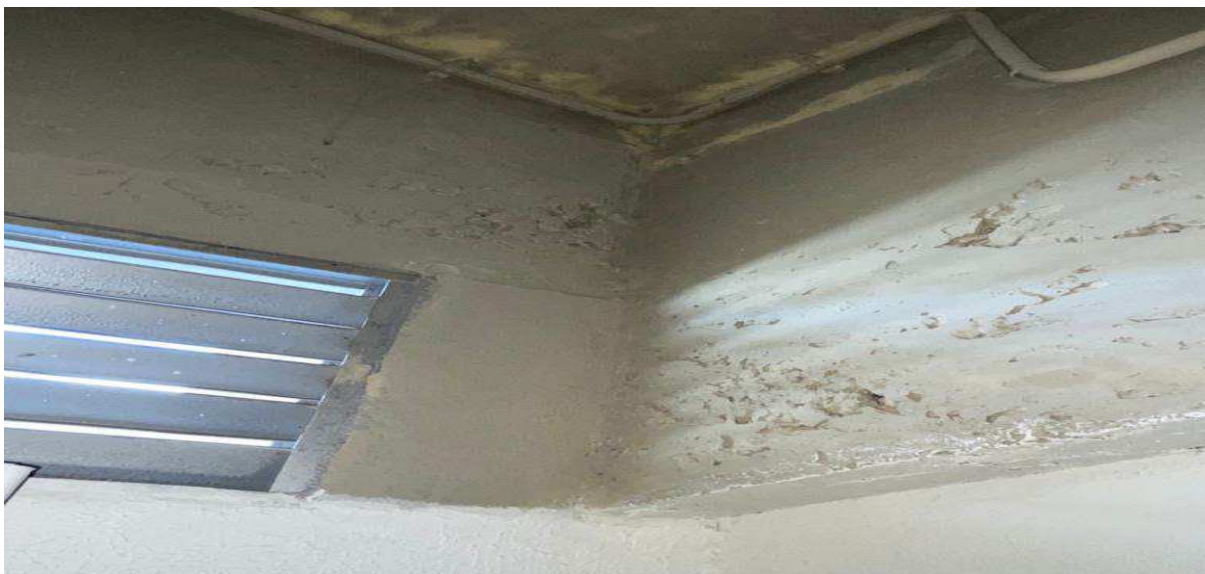
Figura 66: Segregação do concreto em vigas dos vestiários
