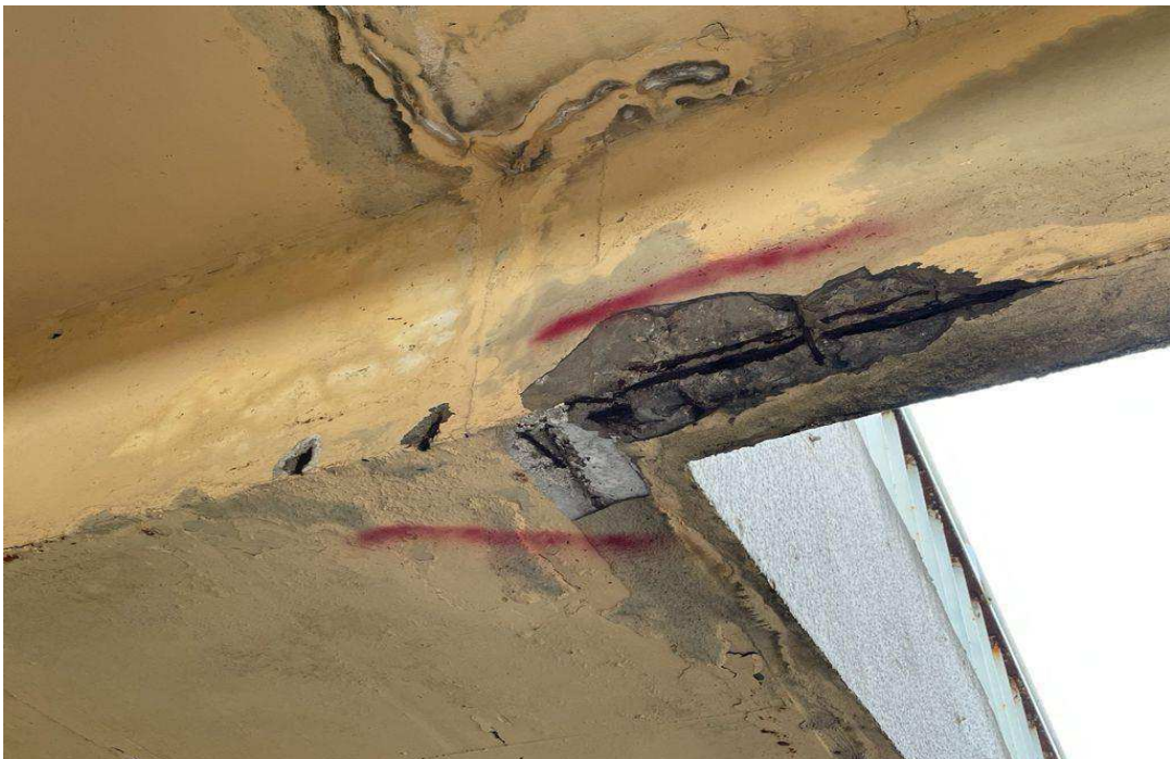
Figura 53: Armadura exposta oxidada no setor sombra
