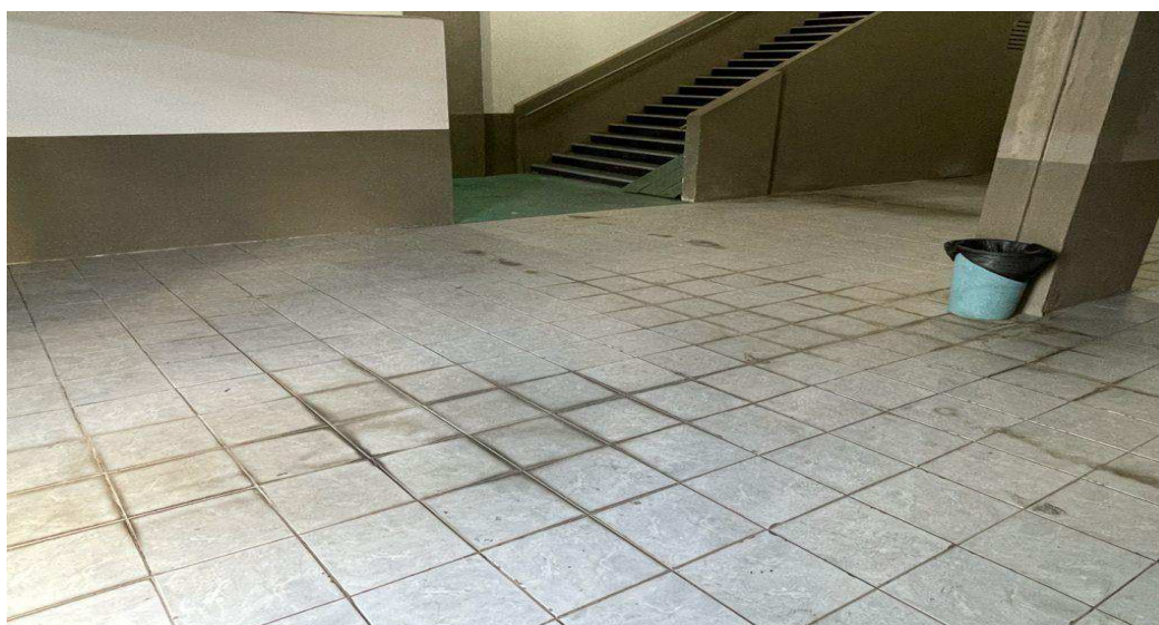
Figura 63: Piso desgastado no acesso aos vestiários
