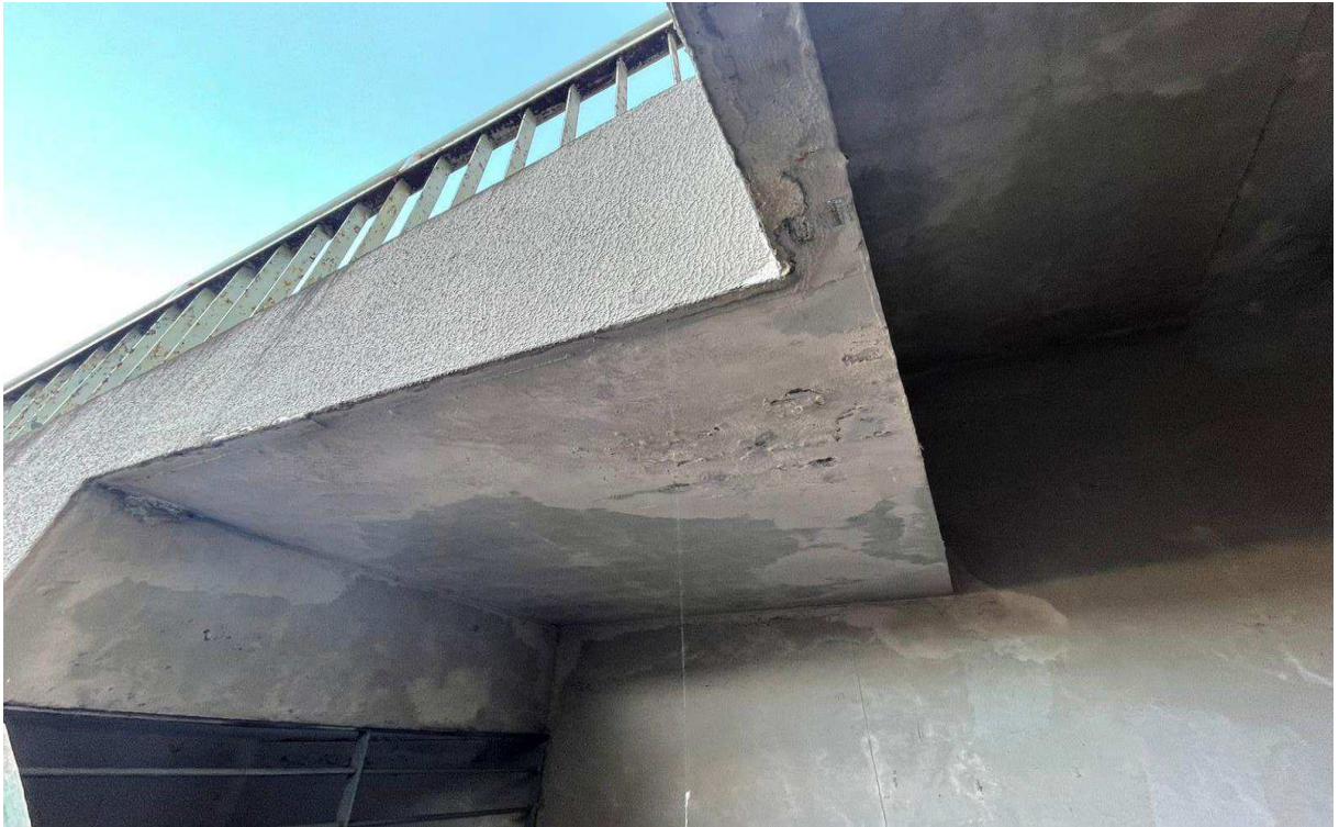
Figura 35: Descascamento provocado por infiltrações no setor sombra
