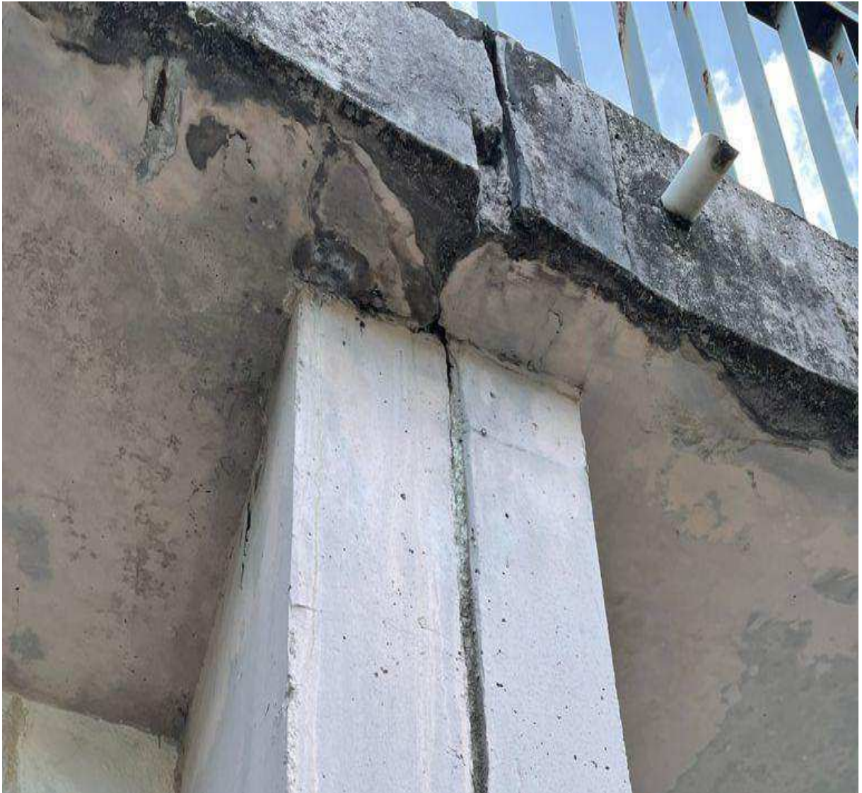
Figura 54: Pequeno trecho de armadura exposta oxidada no fosso do estádio
