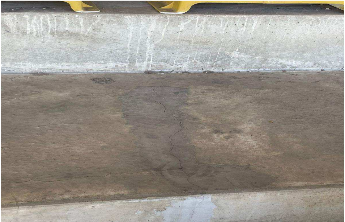
Figura 74: Trinca no setor das cadeiras
