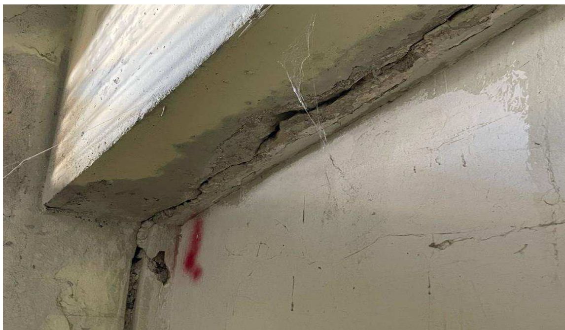
Figura 70: Rachadura em elemento sobre os vestiários
