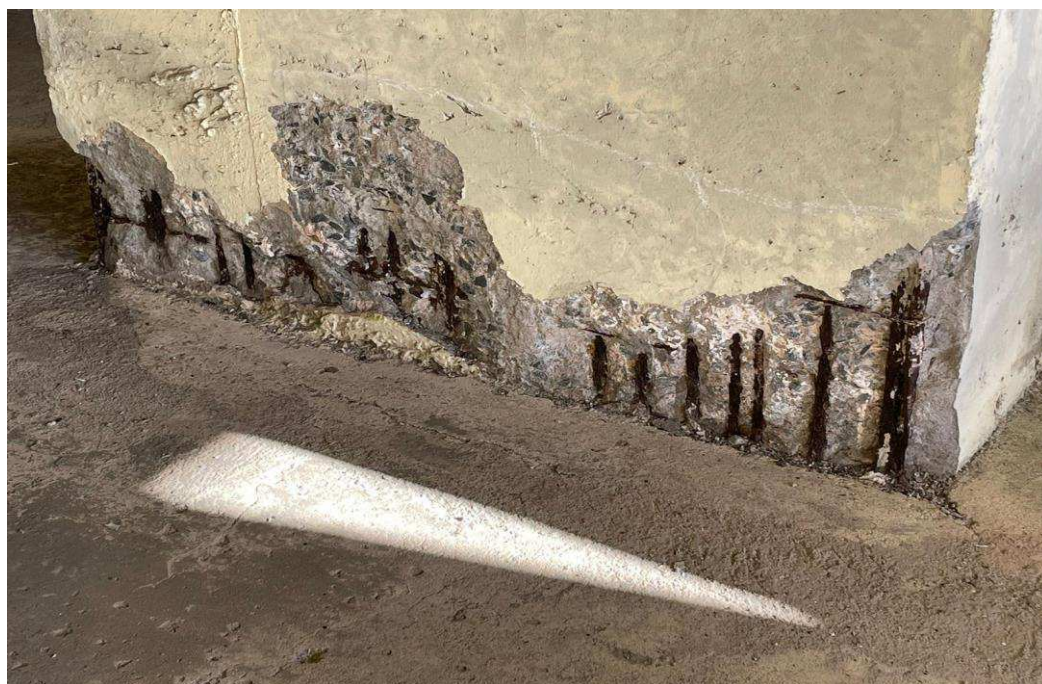
Figura 45: Armadura exposta oxidada em pilar do setor das cadeiras
