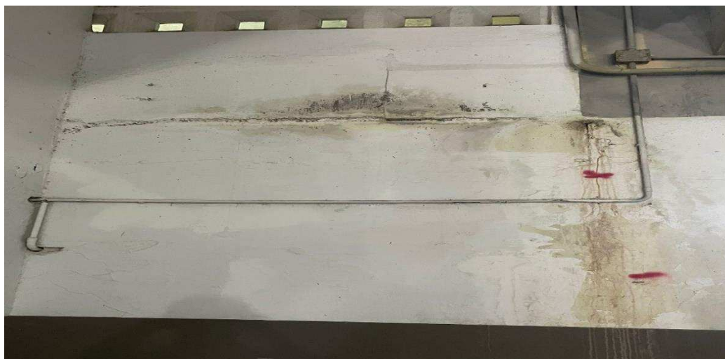
Figura 13: Infiltração no acesso das delegações
