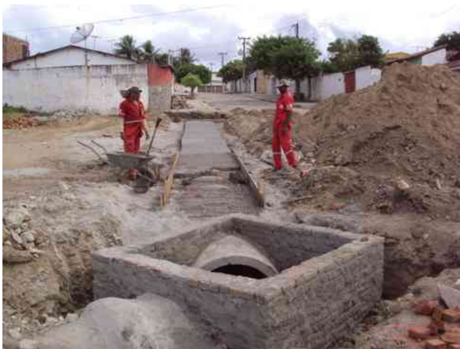
Vista de uma caixa de passagem e outro envelopamento.
