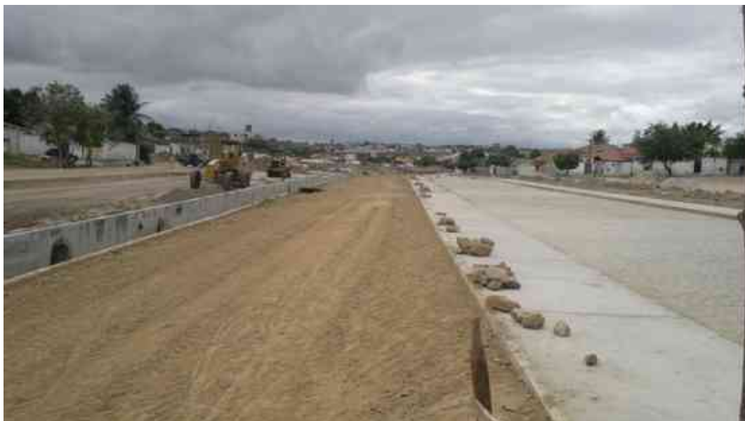
Outro trecho de calçada pronto e preparação do terreno para plantio de grama.
