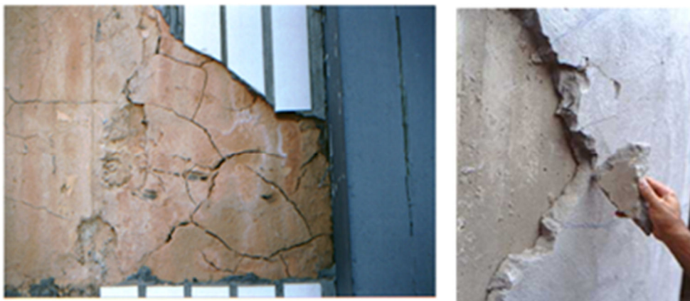
Figura 15 – Fissuras e descolamentos causados pela retração por secagem.
