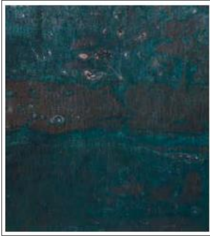
Figura 38. Grau A superfície de aço com carepa de laminação
