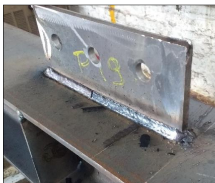
Figura 7. Detalhe de chapa com furos e soldada em pilar metálico
