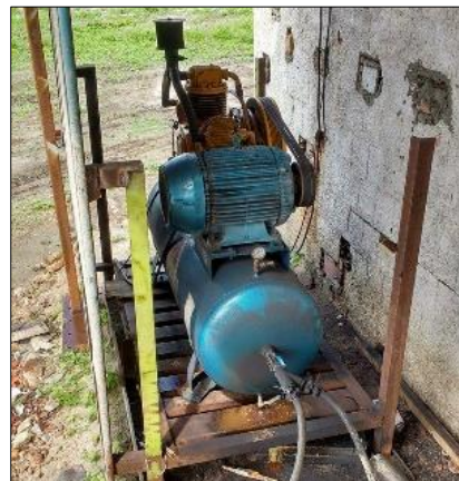
Figura 44. Compressor a ar utilizado no jateamento
