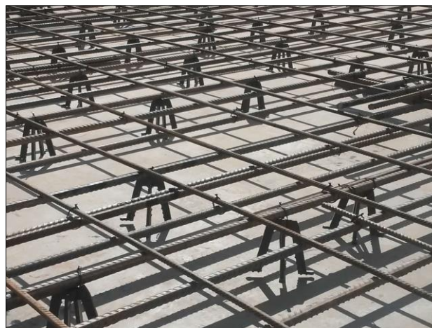
Figura 24. Caranguejos sobre laje
