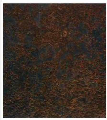
Figura 39. Superfície de aço com início de oxidação e da qual
