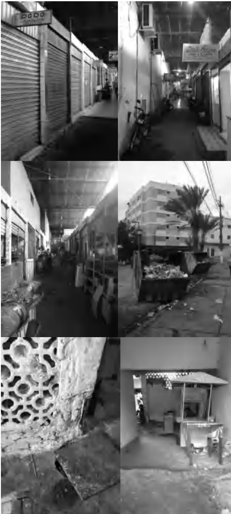
Imagem 71: Aspectos de conflito – Apresentados da esquerda para direita: depósitos térreos e superiores, lixo comendo a fachada posterior, insalubridade e precariedade corredores de acesso
