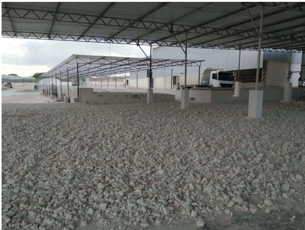
Figura 3.1 - Parte da estrutura de secagem da empresa INCOMGEL
