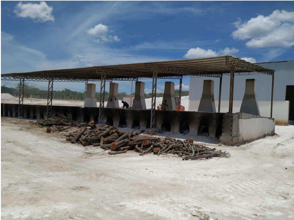
Figura 1.2 - Sistema de secagem utilizando lenha para a secagem de caulim.
