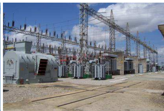
(d) Pátio de uma subestação
