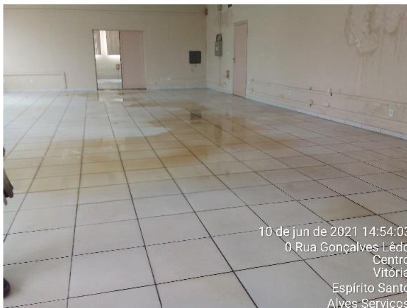
Figura 45 – Sala do terceiro andar após as chuvas
