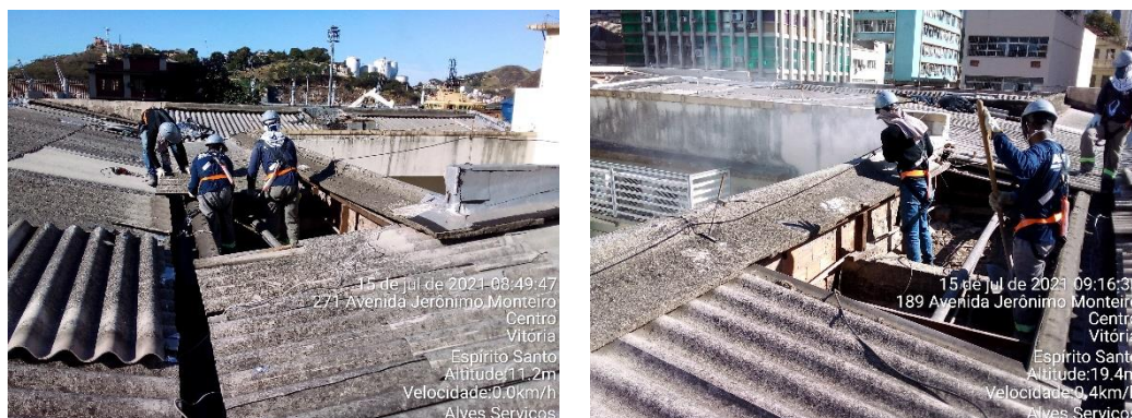
Figura 56 – Destelhamento da área A8
