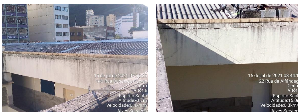
Figura 59 – Fissura das platibandas recuperadas
