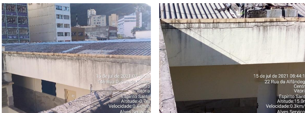
Figura 59 – Fissura das platibandas recuperadas
