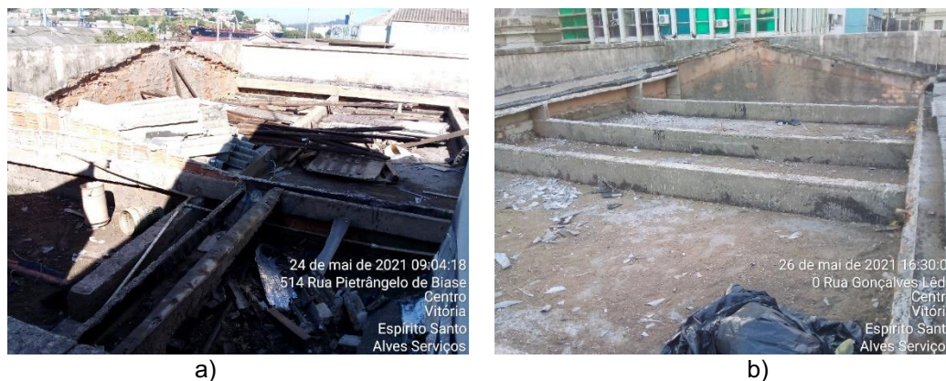
Figura 40 – Platibandas externas. a) platibanda norte - águas 3 e 4 (figura 28) e b) platibanda sul – águas 3 e 4 (figura 28).
