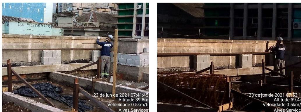
Figura 53 – Rasgo na alvenaria. a) Risco em alvenaria para rasgo e b) rasgo executado.
