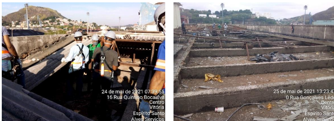
Figura 39 – Destelhamento das águas A3 e A4 e percepção das vigas invertidas
