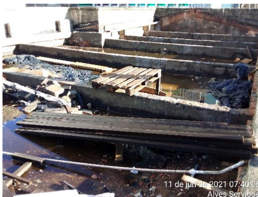
Figura 44 – Laje após as chuvas
