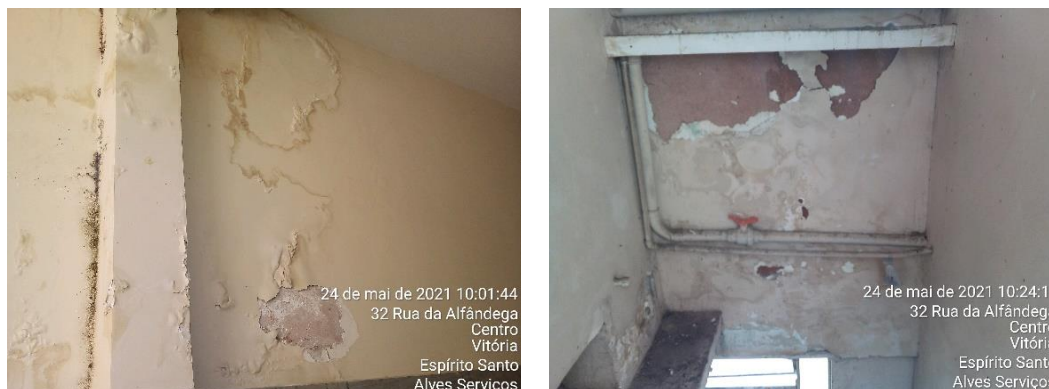
Figura 36 – Descascamento da pintura no terceiro pavimento. (a) parede interna do terceiro pavimento (b) parede da escada de acesso a cobertura, sua face externa compõe a fachada dos fundos.
