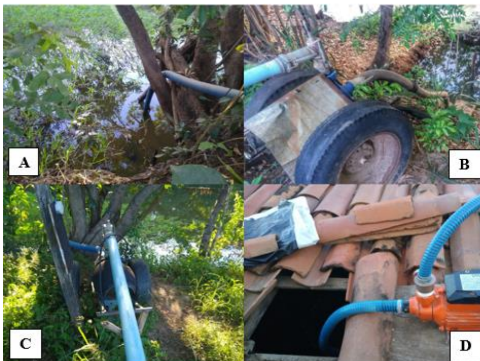
Figura 6 A. Ponto de captação de água às margens do rio Piancó. B e C. Sistema de bombeamento. D. Bombeamento da água distribuída para um reservatório. Fonte: VIEIRA, 2021.
