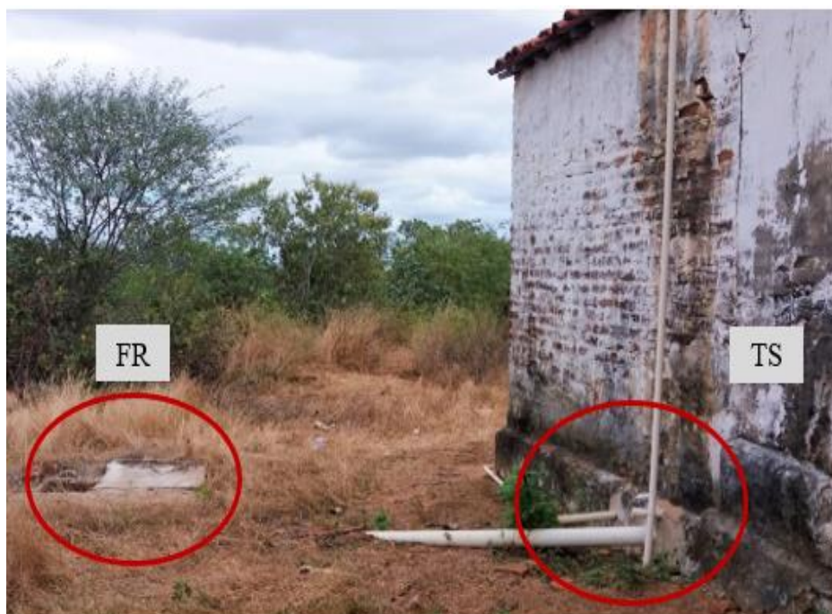
Figura 9. Disposição inadequada dos efluentes domésticos (águas negras).
