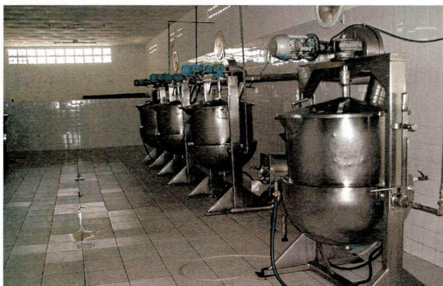
Figura 5 - Tachos de cocção de doces, instalados na Empresa Doce Caseiro Sabor do Sertão.
