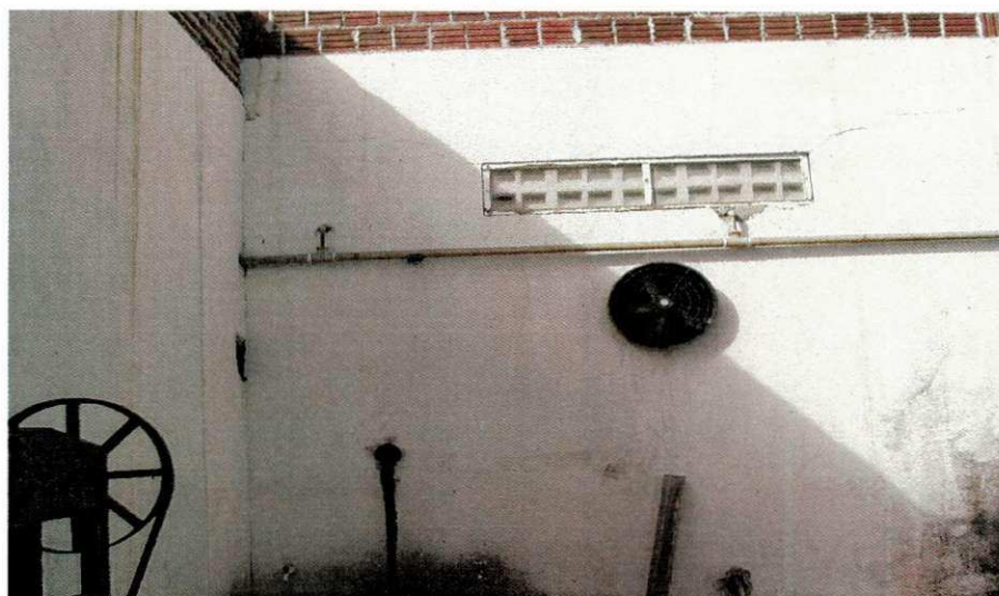
Figura 4 - Linha de vapor (externa), instalada na Empresa Doce Caseiro Sabor do Sertão.
