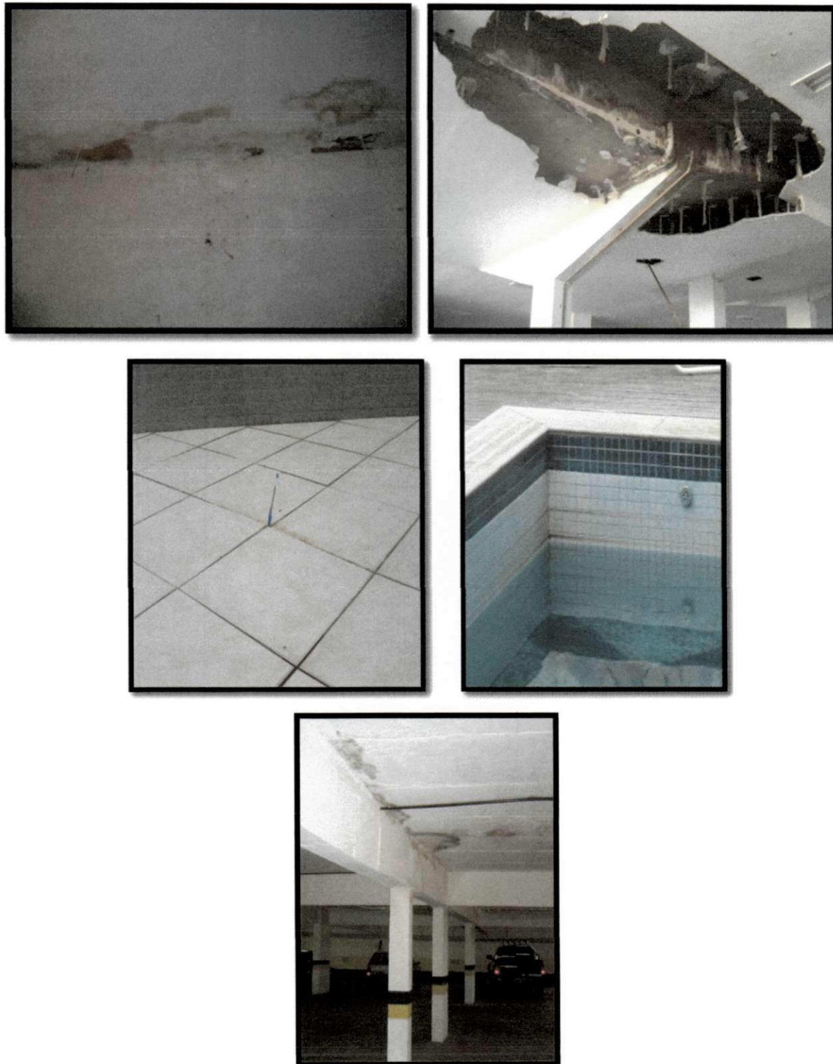
Figura 34: Infiltrações decorrentes de falhas de impermeabilização em piscinas e “decks” a céu-aberto, provocando anomalias em outros elementos como lajes, vigas, pilares e forros de gesso.
