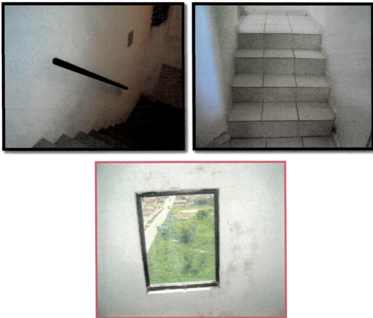
Figura 35: Corrimão incompleto e inadequado, instalado em desacordo com as normas técnicas; escadas sem quaisquer corrimões, com pisos derrapantes; e, finalmente, janela de ventilação/iluminação fixa (não permite abertura) e em completo desacordo com as dimensões estipuladas.
