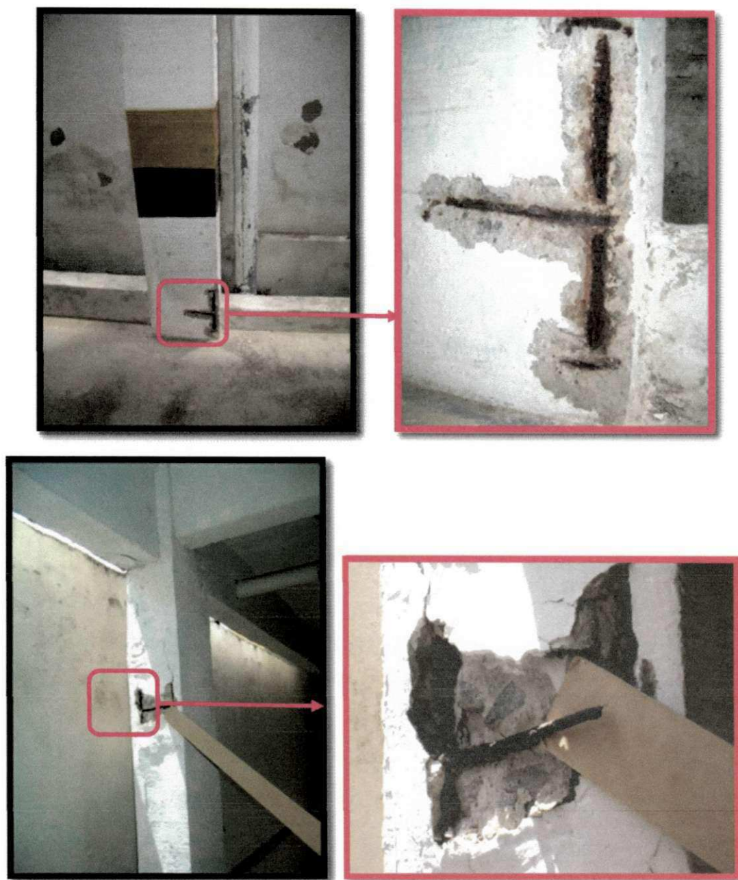
Figura 17: Corrosão/oxidação de armaduras, em pilares, agravadas pela insuficiência de recobrimentos.
