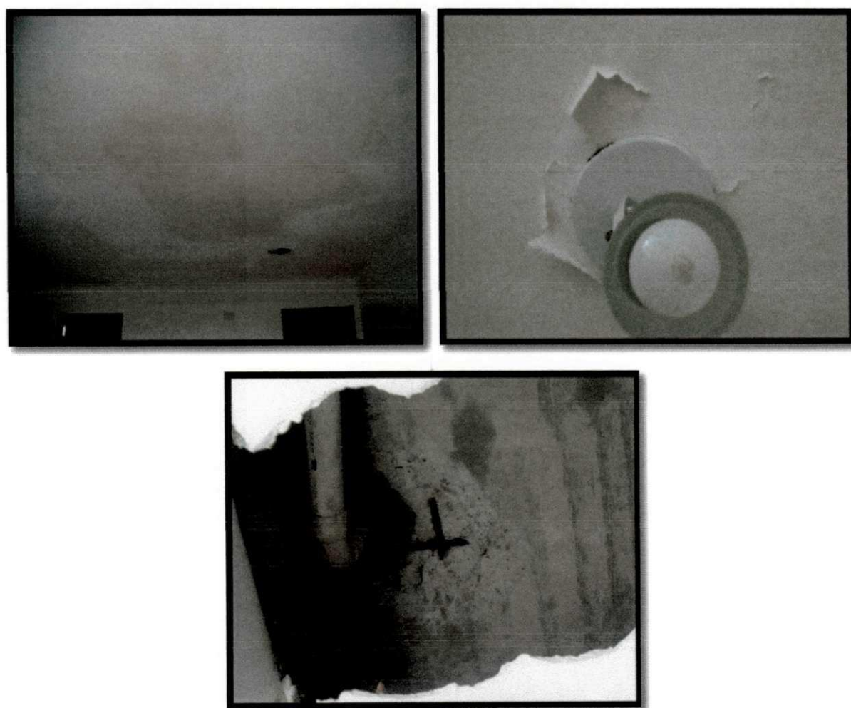
Figura 33: Fissuras entre placas, motivadas por tensões térmicas; mudanças desuniformes de coloração; e infiltrações decorrentes de vazamentos.
