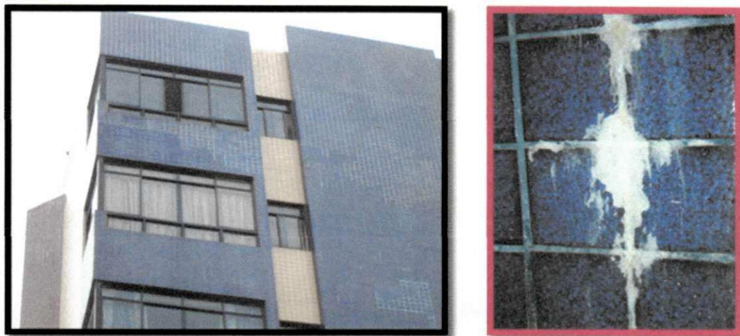
Figura 23: Revestimento com problemas de infiltrações através das juntas entre pastilhas cerâmicas, decorrentes do uso inadequado de materiais e de falhas na aplicação do revestimento; apresentando indícios de insalubridade, expressos por manchas esbranquiçadas sobre o revestimento.
