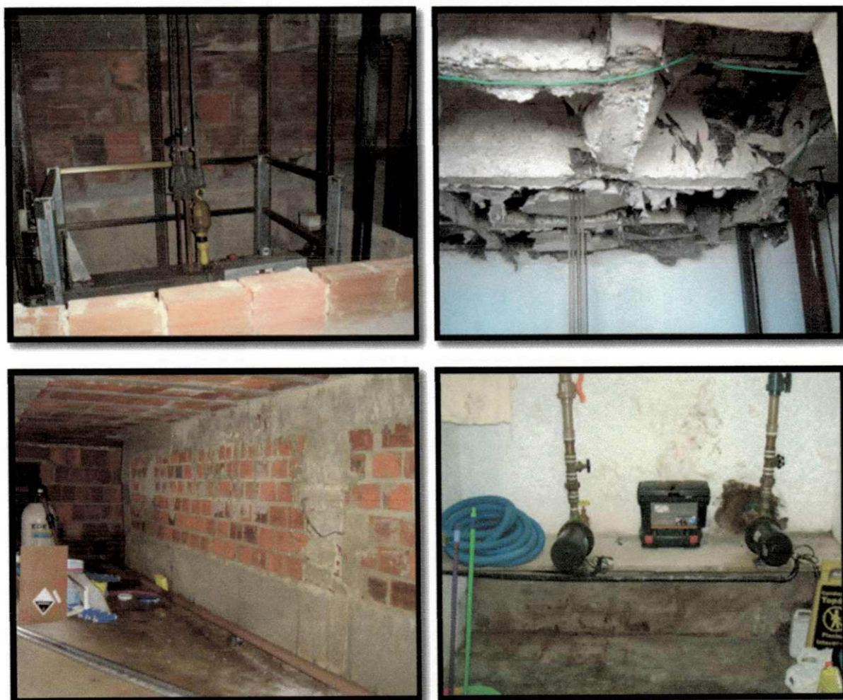
Figura 31: Ambientes privados do devido acabamento final (poços-de-elevadores, área sob “deck” de piscinas e casa-de-bombas, respectivamente).
