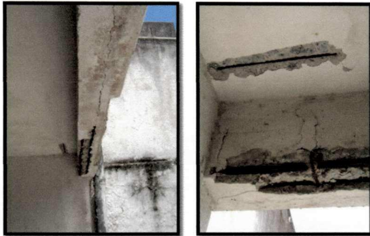
Figura 18: sinais evidentes de desintegração por oxidação/corrosão de armaduras e carbonatação com desagregação do concreto de recobrimento.
