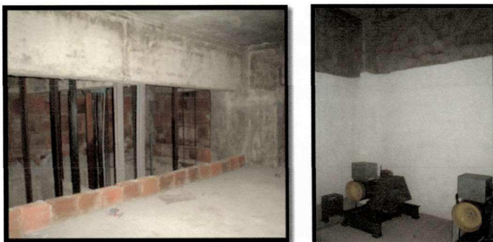
Figura 38: Casa-de-máquinas e poço-de-elevadores desprovidos de acabamento final, de proteção contra acidentes, em prédio munido de competente Habite-se.
