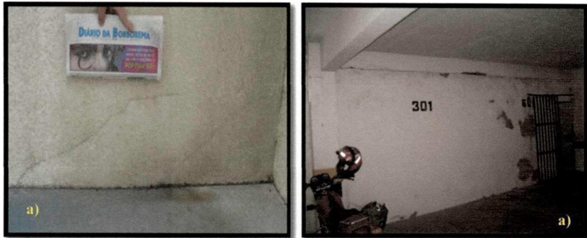
Figura 20: a) Fissuras em parede divisória, indicativas de recalques diferenciais; e, b) existência de paredes de pavimentos térreos, desprovidas de drenagem eficaz, atuando como arrimos de maciços terrosos vizinhos.
