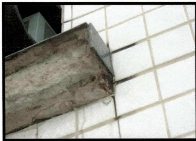
Figura 22: Esfacelamento de emboços e revestimentos, decorrentes de infiltrações parasitas (instalação inadequada de caixas para ar condicionado).
