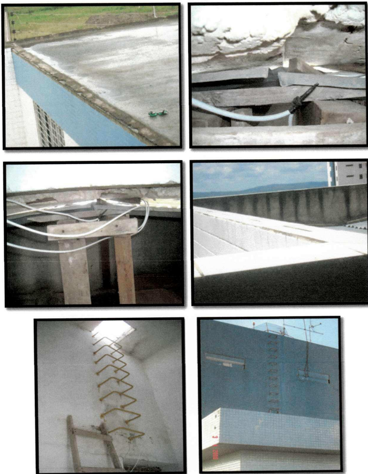
Figura 37: Laje a céu-aberto; Coberturas com estruturas improvisadas; escadas de acesso inapropriadas (sem guarda-corpos); infiltrações em juntas de acabamento e relaxamento de mão-de-obra.
