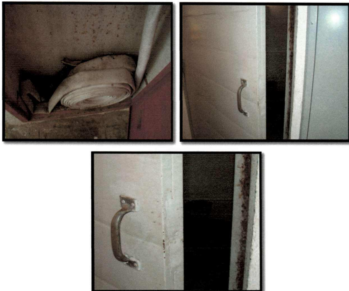
Figura 36: Instalações de incêndio deficientes e portas corta-fogo incompletas e oxidadas, como encontradas em seus estados usuais.
