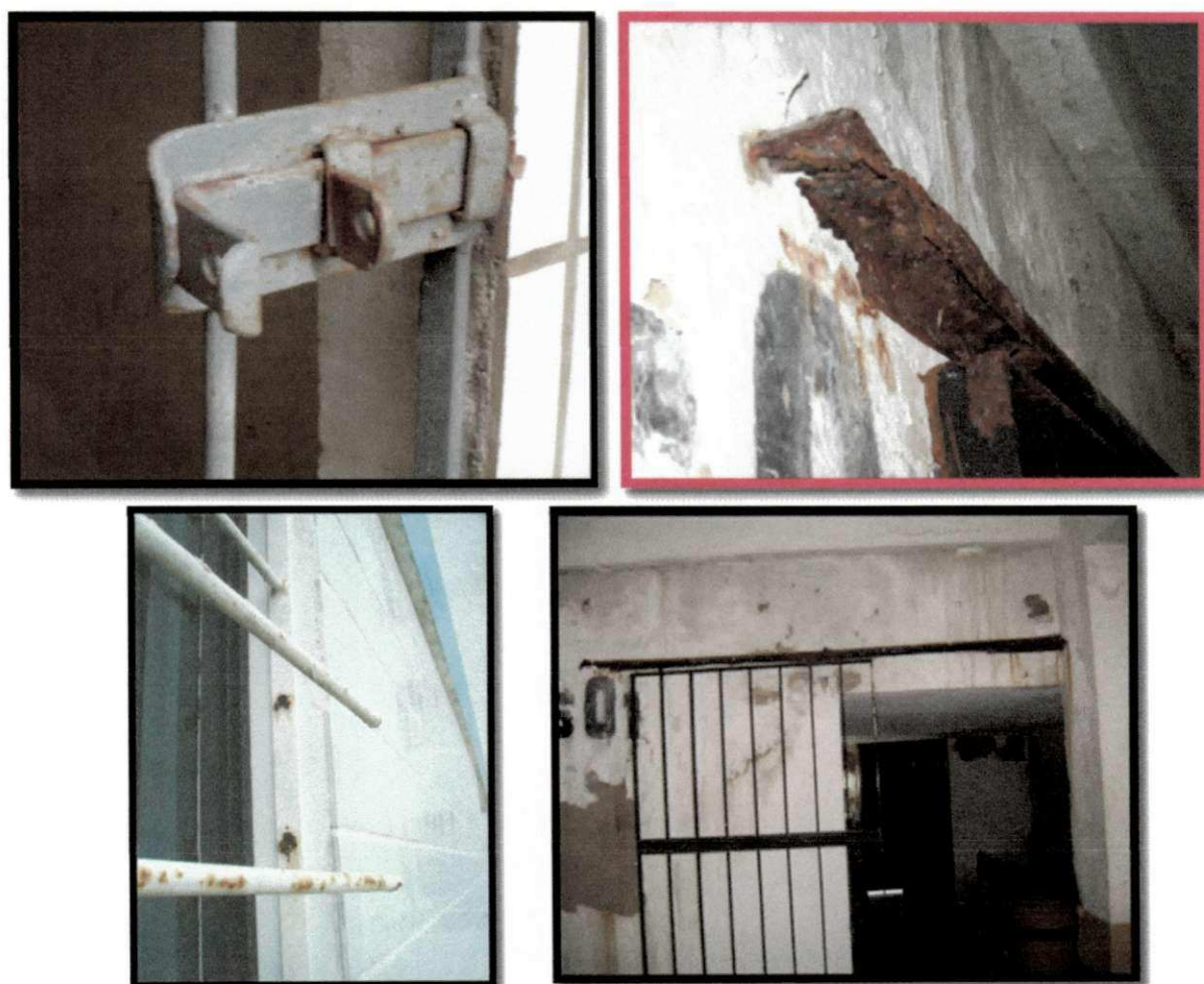
Figura 26: Oxidação de elementos metálicos, requerendo, já, manutenção corretiva (ferragens, como grades de proteção, portões, guarda-corpos e outros, apresentando, apenas, precária proteção da pintura de base dada pelo fabricante, mercedoras que não foram da imprescindível pintura final, em esmalte sintético ou apresentando pintura não-antioxidante).
