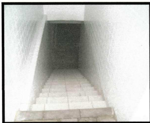
Figura 30: Especificação e emprego inadequados de materiais (escadas a céu-aberto, sem revestimentos antiderrapante e carente de corrimãos).
