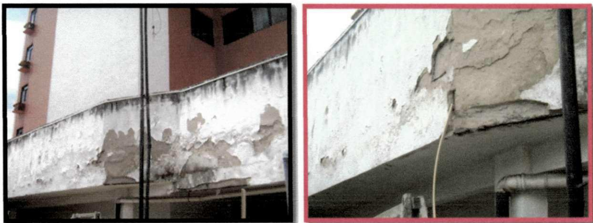
Figura 19: Sacadas com comprometimento de armaduras, em lajes e vigas, em decorrência de danosas infiltrações.
