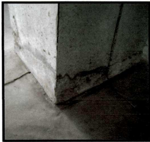
Figura 16: Manifestações preocupantes de eflorescências em pilotis, decorrentes de falta de acabamento das colunas, ou falhas do mesmo; infiltrações de águas servidas e inexistência de drenagem adequada para rebaixamento do lençol freático.
