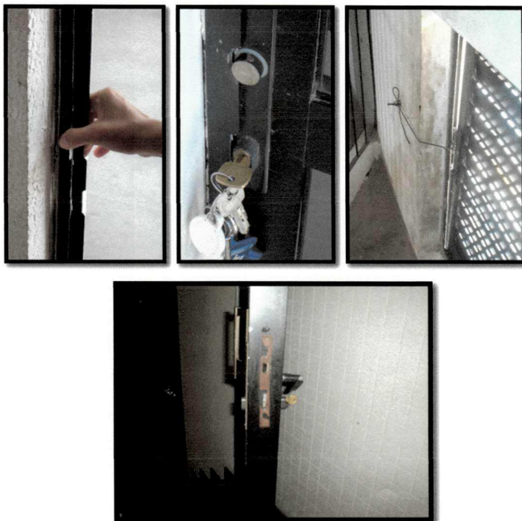
Figura 28: Falhas na instalação de elementos metálicos, provocando perda de mobilidade e/ou deficiência na abertura e fechamento dos mesmos, além de incompatibilidade entre materiais.
