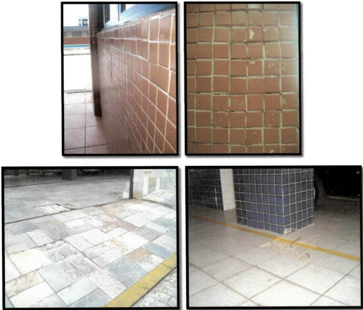
Figura 29: Evidente relaxamento de mão-de-obra, na aplicação de revestimentos.
