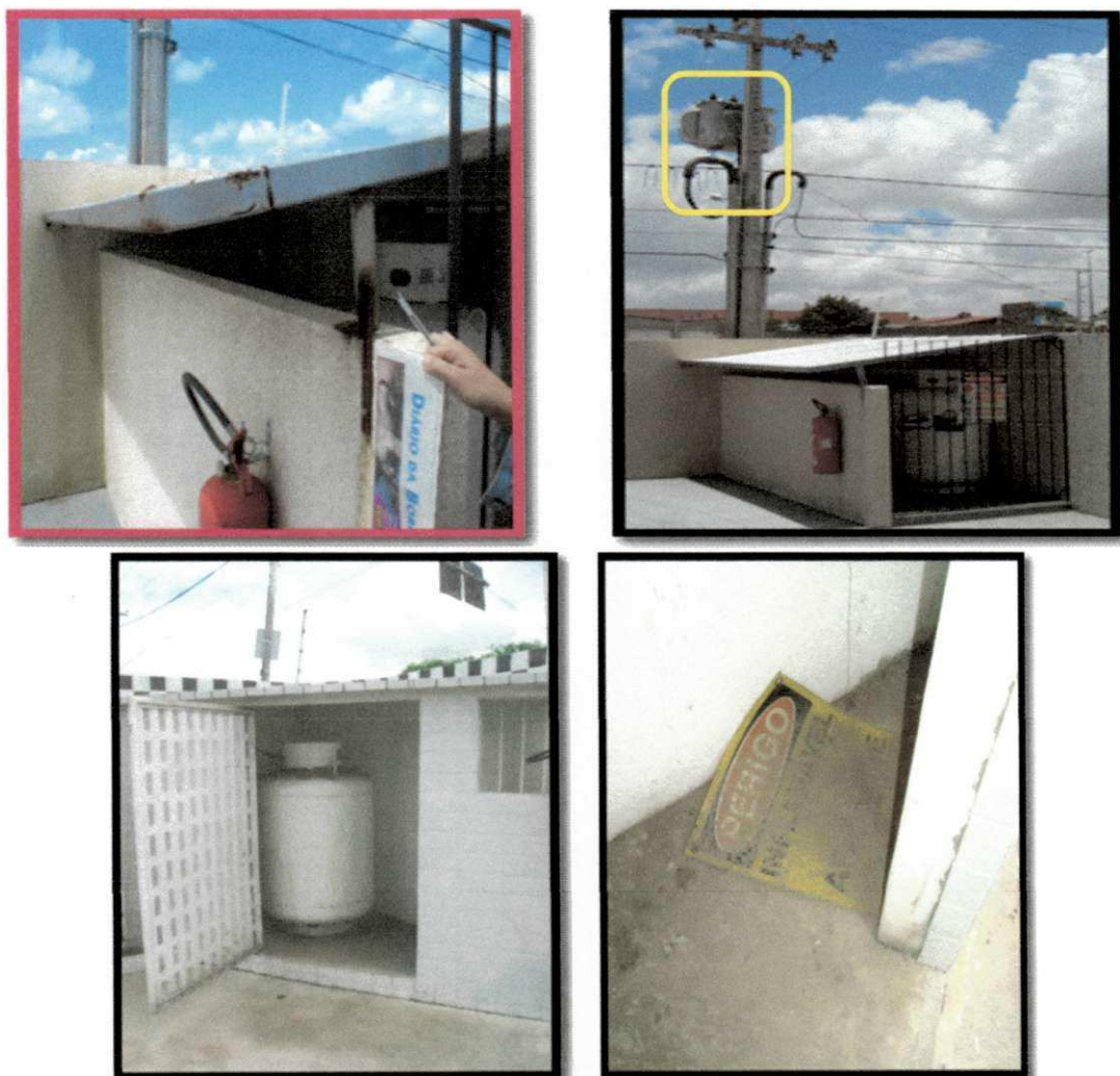
Figura 39: Centrais de gás no entorno de redes elétricas, incluindo postes com transformadores; observem-se oxidações em estrutura de cobertura e “aviso de perigo” em local inusitado.
