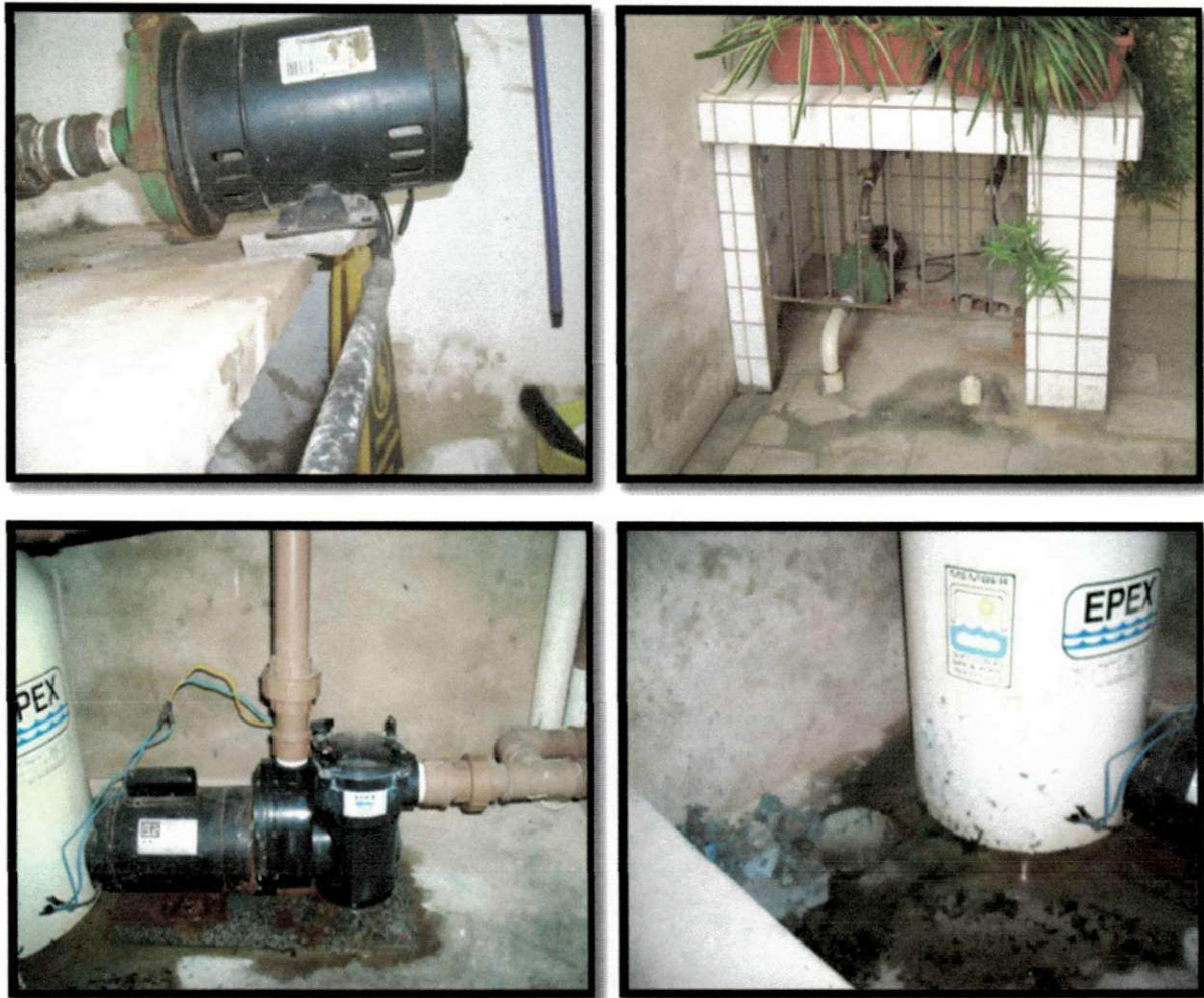
Figura 41: Exemplos de extrema negligência com equipamentos eletromecânicos, com instalações hidrossatúrias, bem como, mais uma vez, do desapareço com que são tratadas questões inerentes a manutenção.
