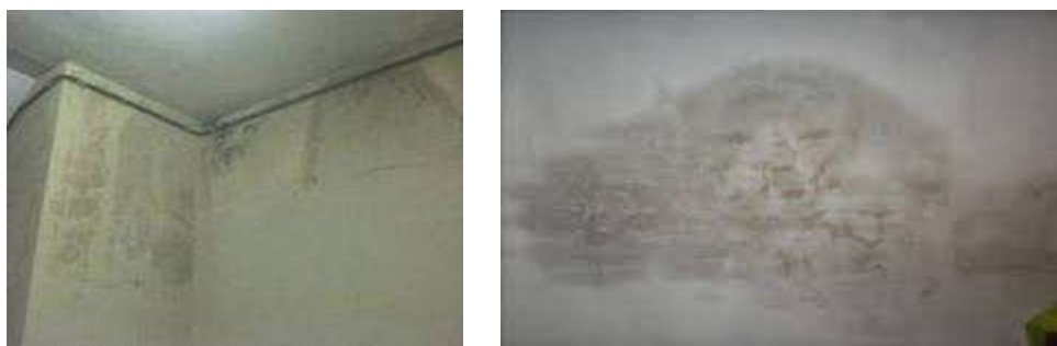
Figura 3 - Infiltração de água nas paredes
