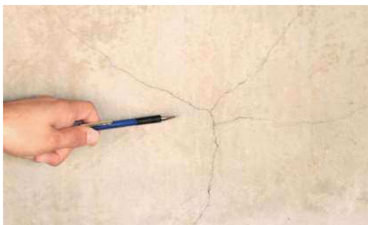
Figura 2 - fissuras em alvenaria
