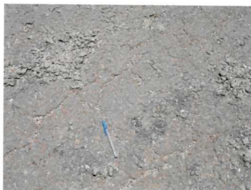
Figura 2.6: Trincas interligadas, com aparecimento das camadas inferiores para as superiores do pavimento, PB 306, trecho Maturéia à Princesa Isabel
