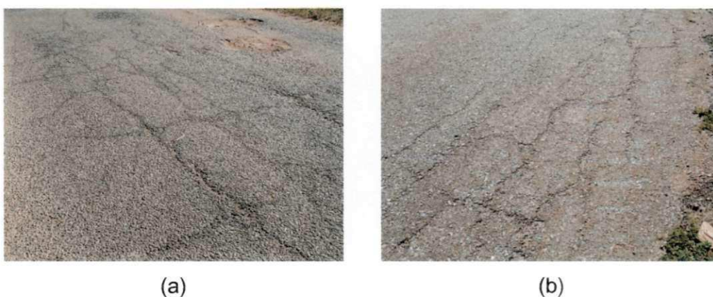
Figura 2.5: Trincas interligadas, PB 306, trecho Maturéia à Princesa Isabel (a) Trincas interligadas em bloco (b) Trincas interligadas couro de jacaré
