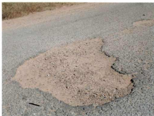
Figura 2.7: Panelas resultantes da deterioração do pavimento, PB 306, trecho Maturéia à Princesa Isabel
