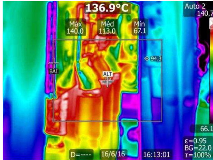
Figura 43: Termovisão nos cabos do parque 5.
